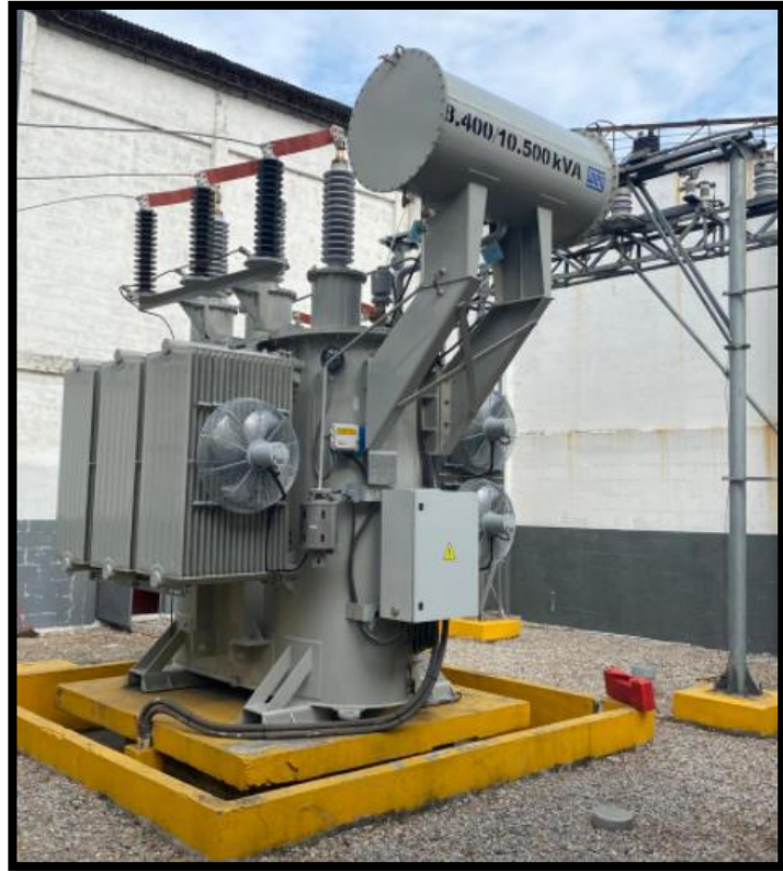
FIGURA 1: TRANSFORMADOR DE POTENCIA. FUENTE: [3]
