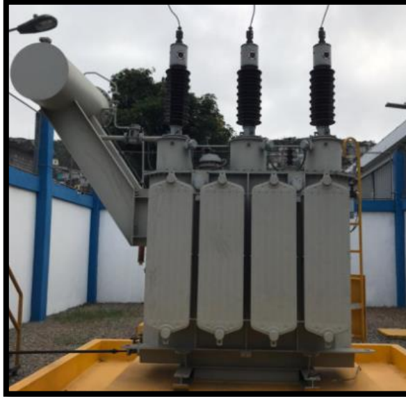
FIGURA 22: TRANSFORMADOR DE POTENCIA 2.5 MVA. FUENTE: [3]
