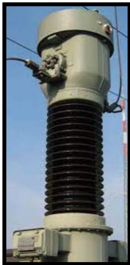
FIGURA 25: TRANSFORMADOR DE CORRIENTE. FUENTE: [3]
