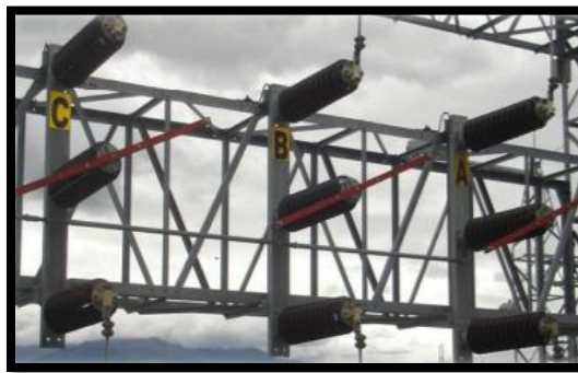
FIGURA 24: SECCIONADOR 69 KV. FUENTE: [3]
