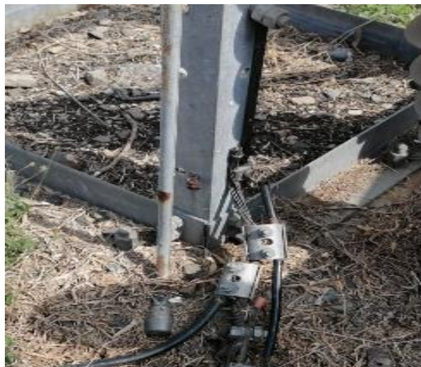
Figura 2.9. Conductor de protección existente
