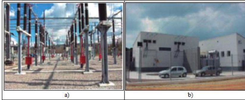
Figura 1.6. Subestación eléctrica de a) intemperie y b) interior
