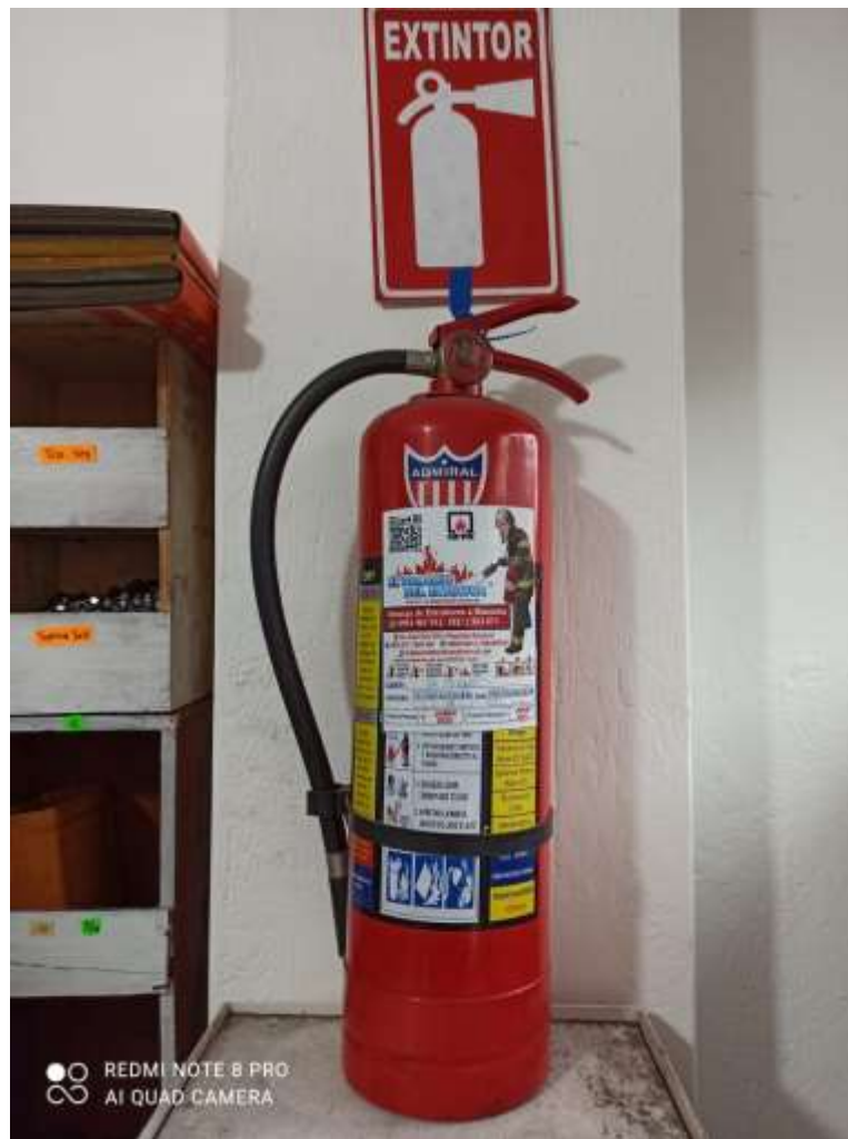
Figura 40. Extintor del almacén. (Elaborado por: Erick Martínez)
