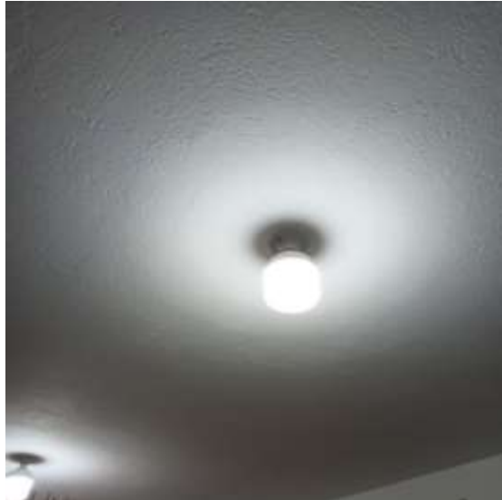
Figura 47. Luminaria del almacén. (Elaborado por: Erick Martínez)
