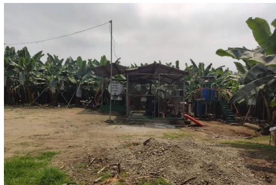
Figura 4. Sistema de riego N°2 de la hacienda San Alejandro, vista lateral.
