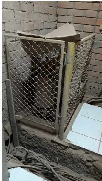
Figura 2.5: Transformador de 440/220-127 V
