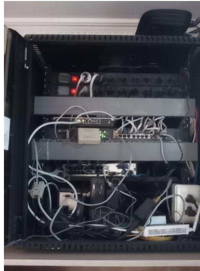
Figura 2.5 Rack de servicio de la matriz principal
