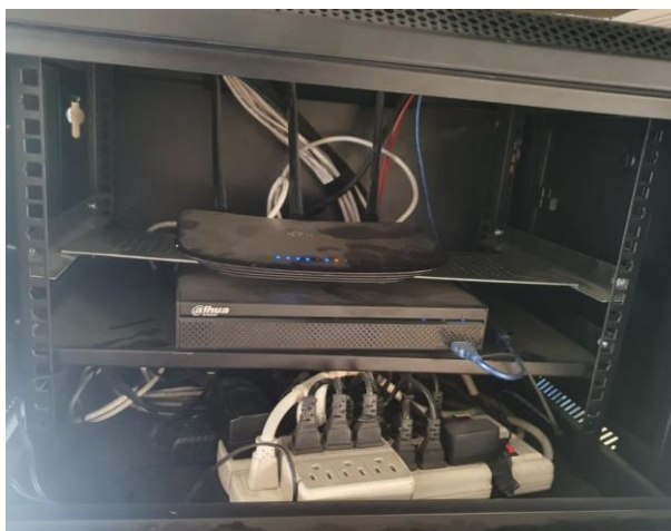
Figura 2.6 Rack de servicio del departamento de hornos
