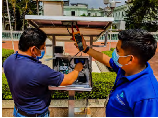
Figura 5.9: Toma de medidas y verificación de funcionamiento del monitor externo.
