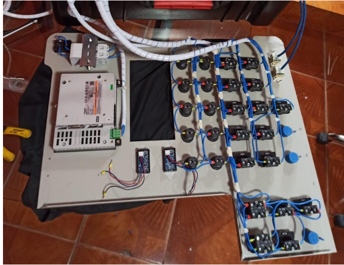
Figura 48. Cableado de elementos de control PLC M241
