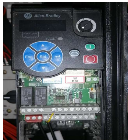
Figura 36.Variador de frecuencia implementado
