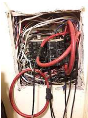
Figura 3.4. Instalación de analizador fluke en el circuito de alimentación del calentador de inducción. Fuente: Power Log Classic
