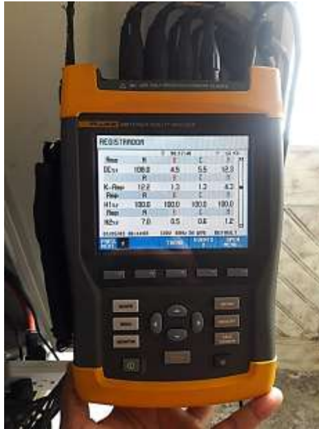
Figura 2.13.2.3. Analizador en el PCC del Hotel Old Town Quito Suites. Fuente: Diego Játiva.
