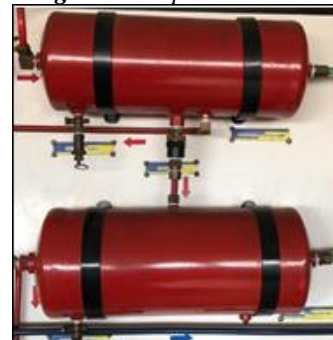
Figura 6. Depósito de aire.
