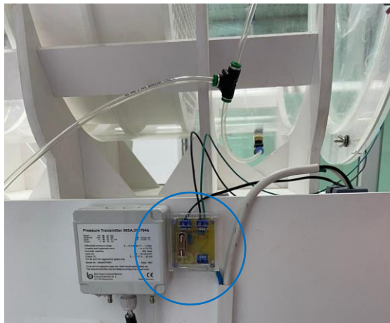
Figura 21. Implementaciones realizadas en el túnel de viento. Fuente: [Autor].
