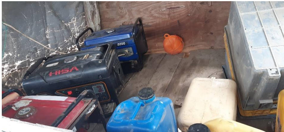
Figura 20. Generadores Eléctricos a combustión
