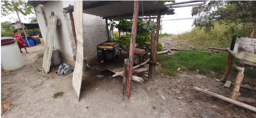
Figura 19. Generadores Eléctricos a combustión
