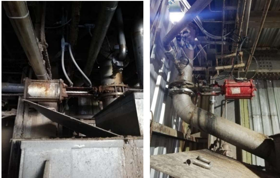
Válvulas Neumáticas Fuente: Área de Preparación Pasta
