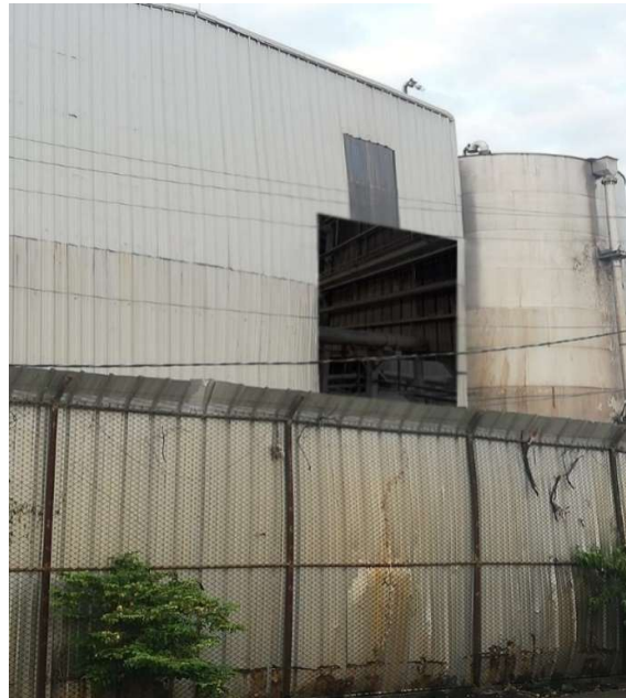
Falta de Steel Panel Fuente: Elaboración Propia
