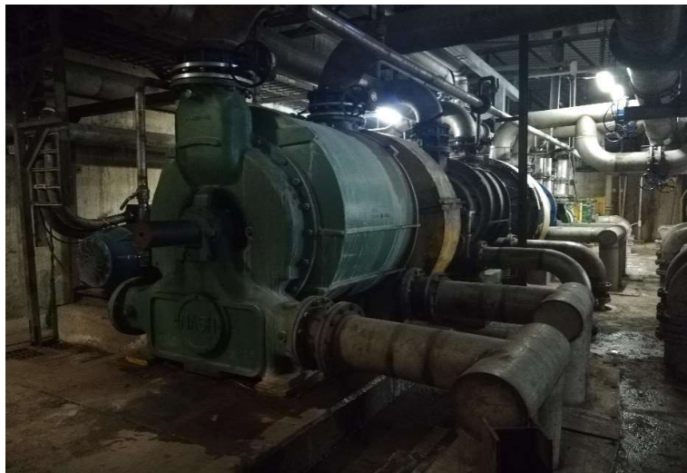
Bombas Centrifugas Fuente: Cuarto de Bombas de Vacío
