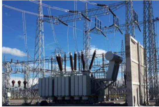
Figura 2.16: Subestación Santa Elena [20]
