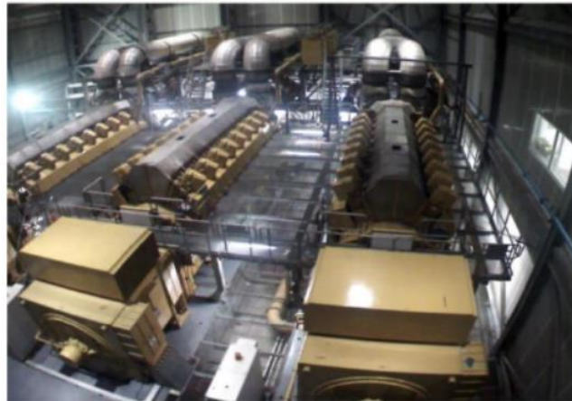
Figura 2.10: Generadores Caterpillar de la generadora Central Santa Elena 3 [20]
