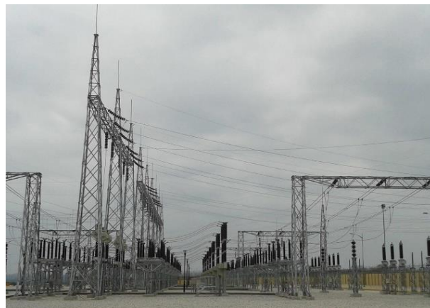
Figura 2.12: Subestación Lago de Chongón [20]
