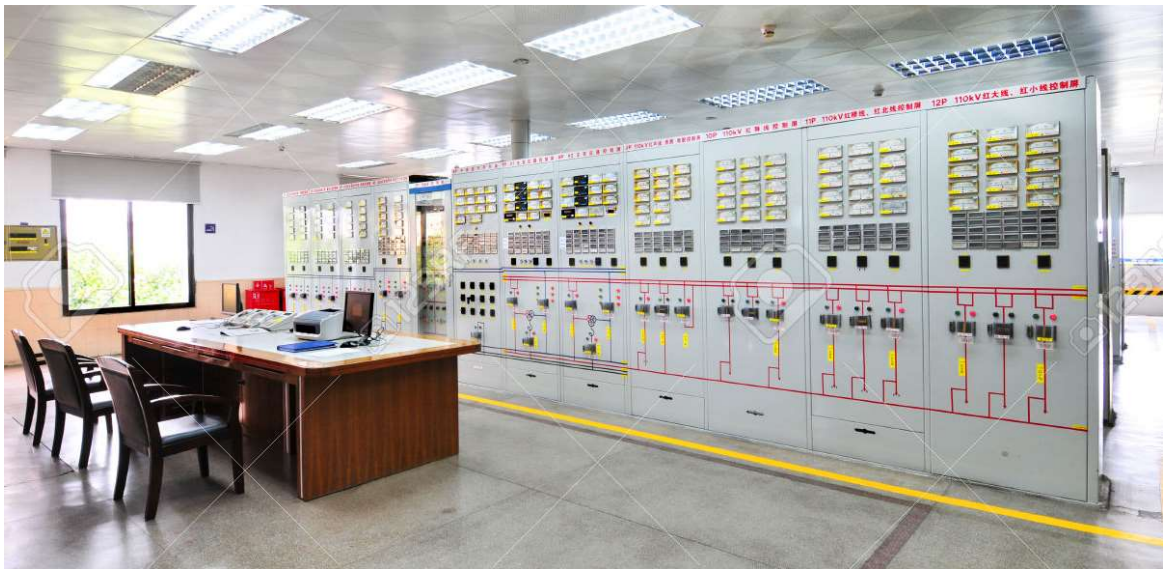
FIGURA 10: Sala de control de una subestación, equipos de medición, indicadores, selectores, relés de protección. Fuente: [13].
