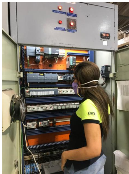
Figura 94. Comprobación de la correcta instalación de los componentes en el tablero de mando y control.
