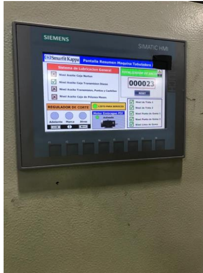
Figura 91. Pantalla HMI KTP700 instalada
