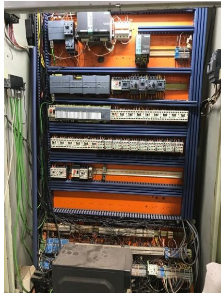
Figura 89. Tablero de mando y control
