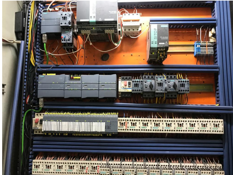
Figura 8. Panel de control administrado por PLC.
