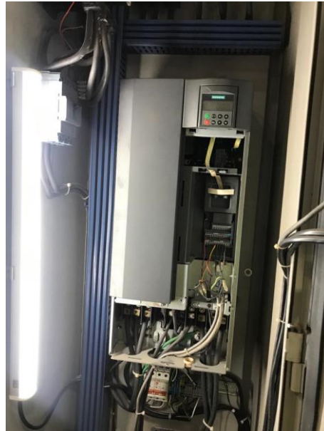
Figura 90. Tablero del variador
