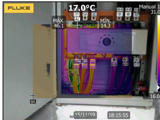
Figura 14. Análisis térmico del tablero “ATS”.
