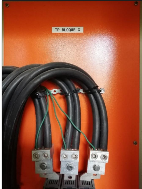
Anexo 5.1. Entrada del 11, 12, 13 al interruptor principal del bloque "G".
