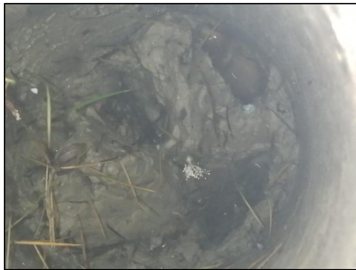
Anexo 7.3. Puesta a tierra. dentro del tubo PVC que protege la puesta a tierra.
