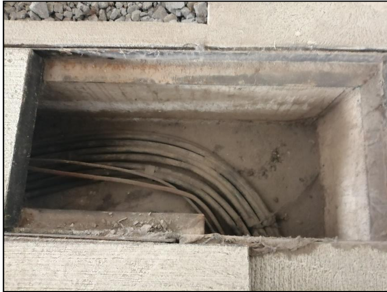
Anexo 2.3. Canalización para los conductores del transformador a la barra.
