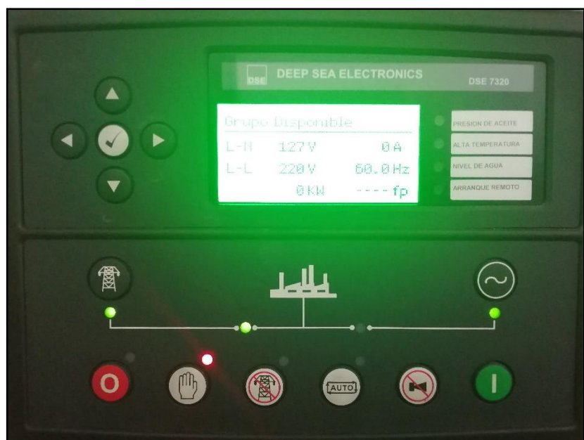
Anexo 3.1. Panel de control del generador.
