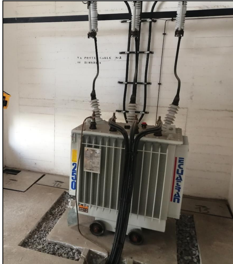
Anexo 2.1. Transformador general.
