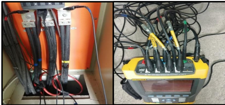
Figura 17. Conexión del analizador fluke en el interruptor del bloque “G”.
