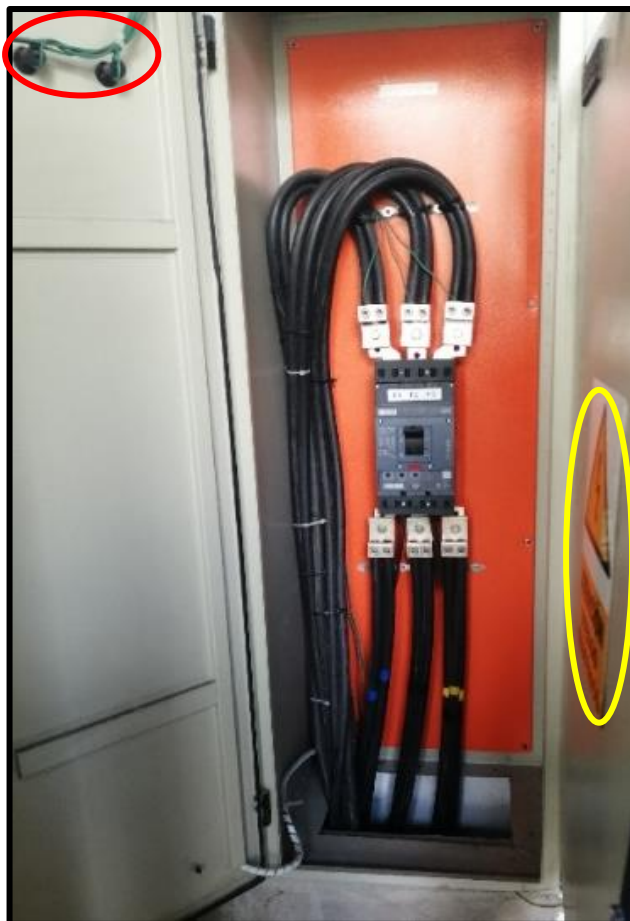
Figura 15. Interruptor siemens 3VT3 del bloque “G”.
