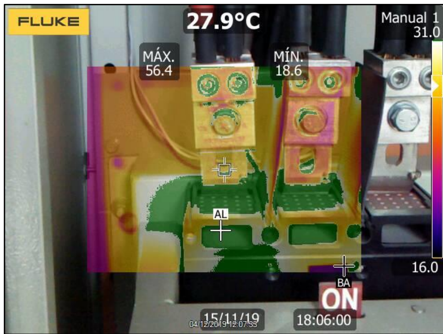
Anexo 4.5. Análisis térmico de la entrada del transformador al ATS.
