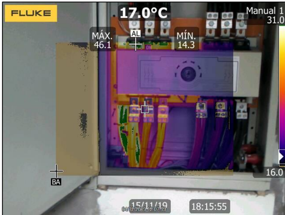
Anexo 4.8. Análisis térmico de la entrada del generador al ATS.
