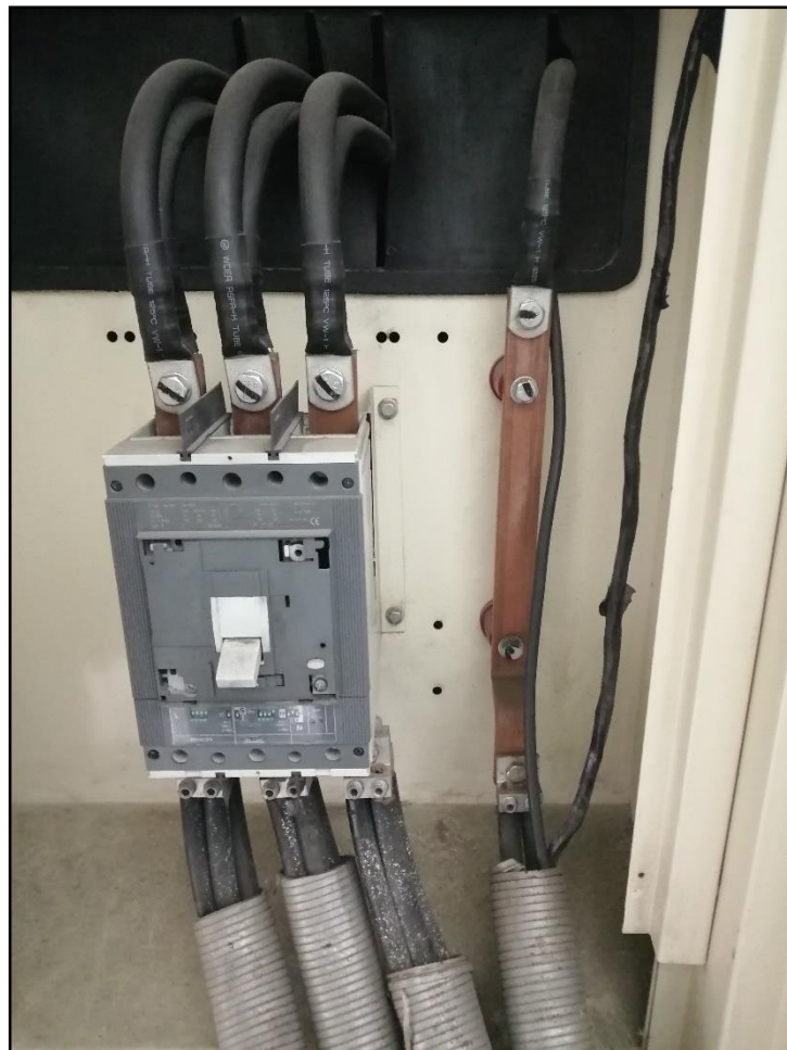
Anexo 3.3. Interruptor principal del generador.
