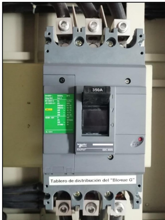
Anexo 6.2. Interruptor principal del tablero secundario del bloque “G”.
