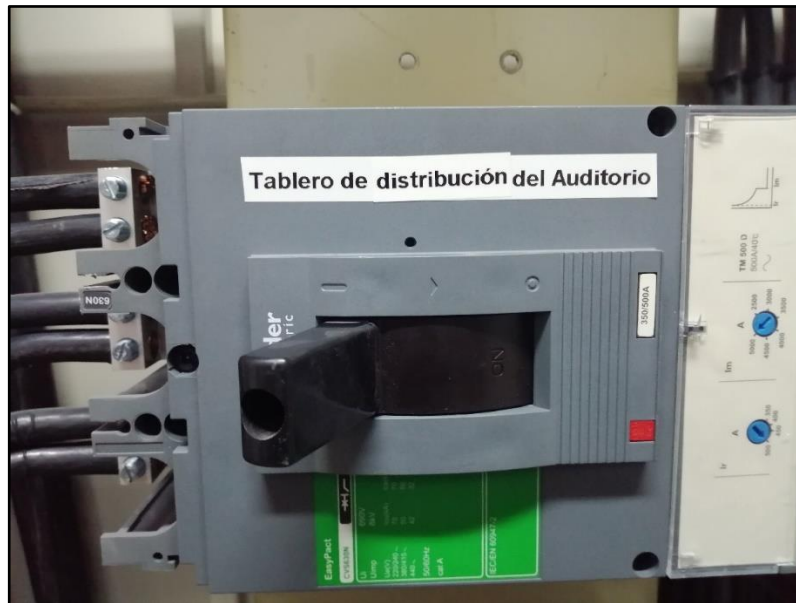
Anexo 6.4. Interruptor del tablero de distribución del auditorio.
