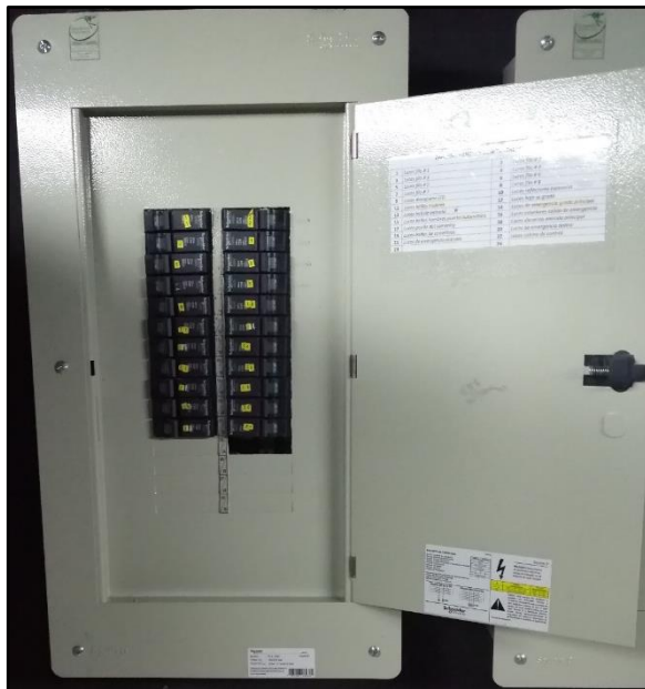
Anexo 6.12. Tablero secundario de los auditorios, fuerza e iluminación.
