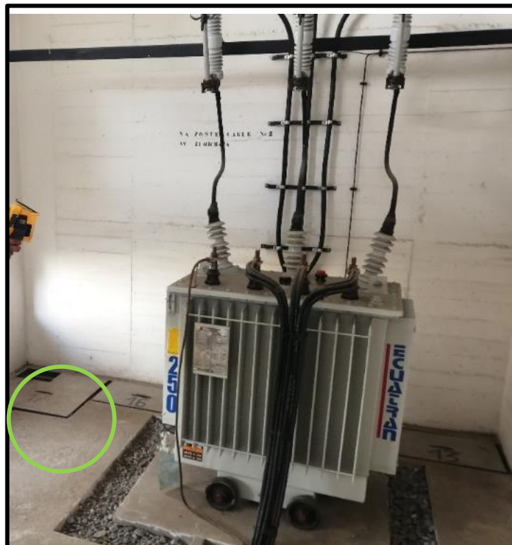
Figura 9. Transformador principal de 250 [Kva]
