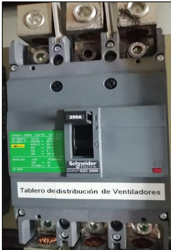
Anexo 6.5. Interruptor del tablero secundario de la distribución de ventilación.
