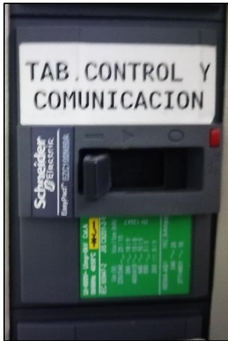
Anexo 6.7. Interruptor del tablero secundario de control y comunicación del bloque “G”.
