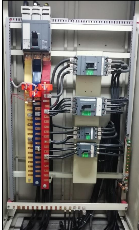
Anexo 6.1. Tablero secundario del bloque “G”
