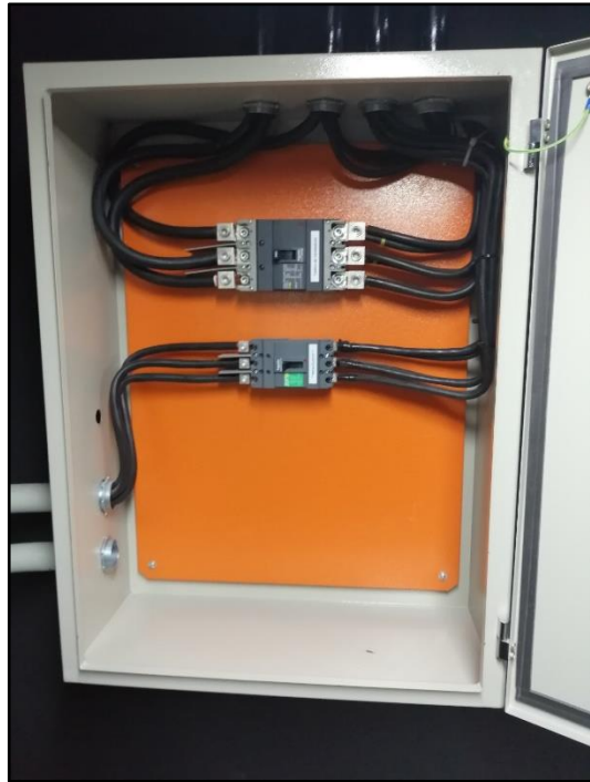
Anexo 6.11. Tablero secundario de los auditorios, ventilación.
