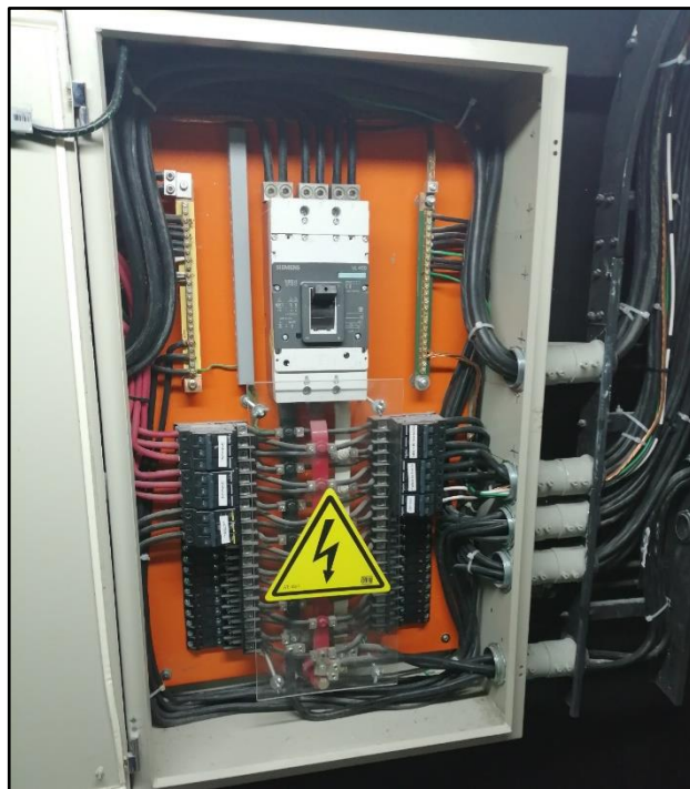
Anexo 6.10. Tablero secundario de los auditorios.
