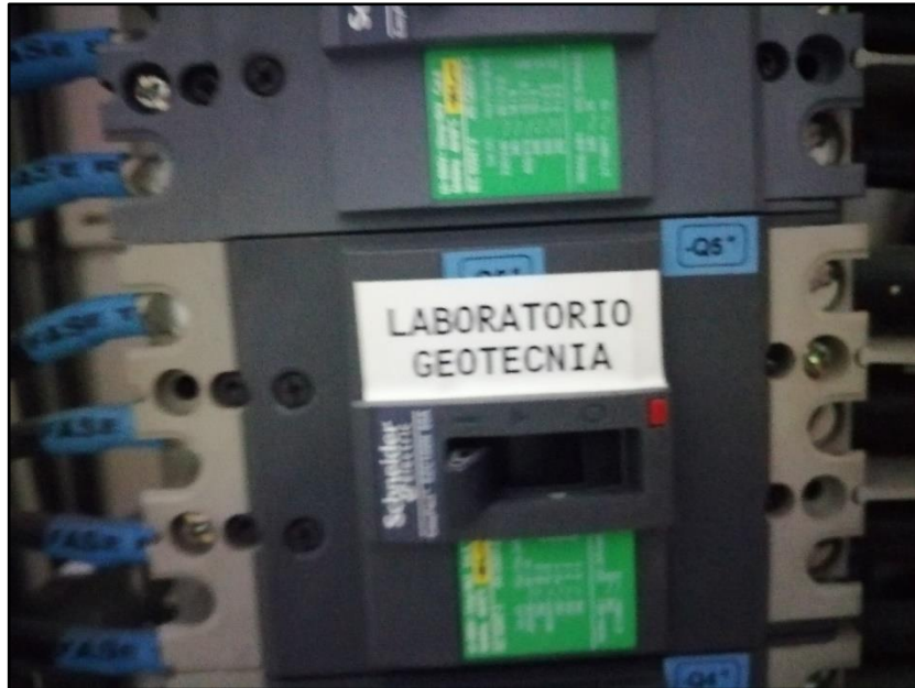
Anexo 6.9. Interruptor del tablero secundario de geotecnia del bloque "G".
