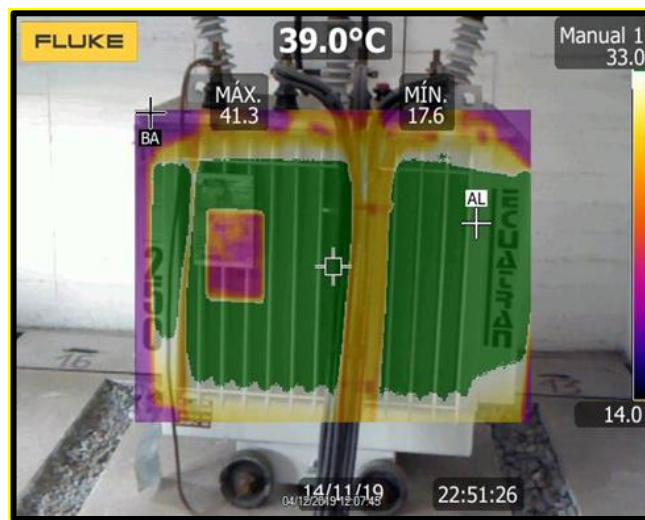
Figura 10. Transformador principal de 250 Kva análisis térmico
