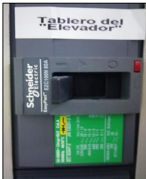
Anexo 6.6. Interruptor del elevador, tablero secundario del bloque "G".
