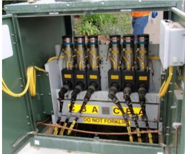
Figura 4. Interrupedor tipo pedestal
