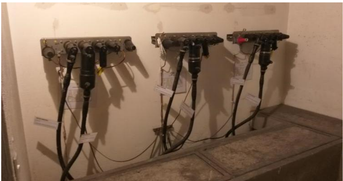
Fotografía 3. Pozo eléctrico existentes aledaños al edificio LENNON.
