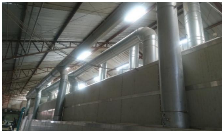
Figura 23. Ventilación en las cabinas [Cortesía de la empresa].
