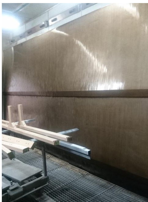
Figura 21. Cabinas de aplicación de recubrimiento [Cortesía de la empresa].
