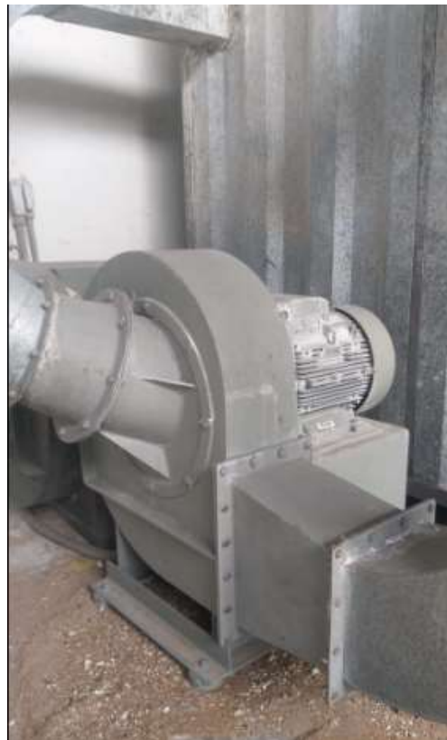
Figura 33 Ventilador centrífugo instalado
