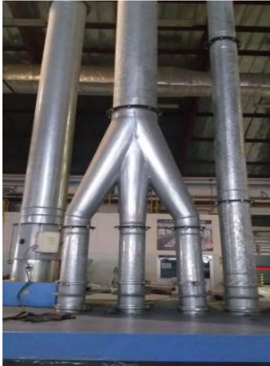
Figura 32 Tuberías de trasportes de partículas
