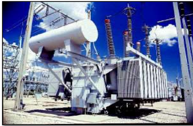
FIGURA 18 TRANSFORMADOR DE POTENCIA [9]
