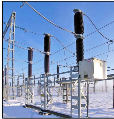
FIGURA 20 :INTERRUPTOR TANQUE VIVO [14]
