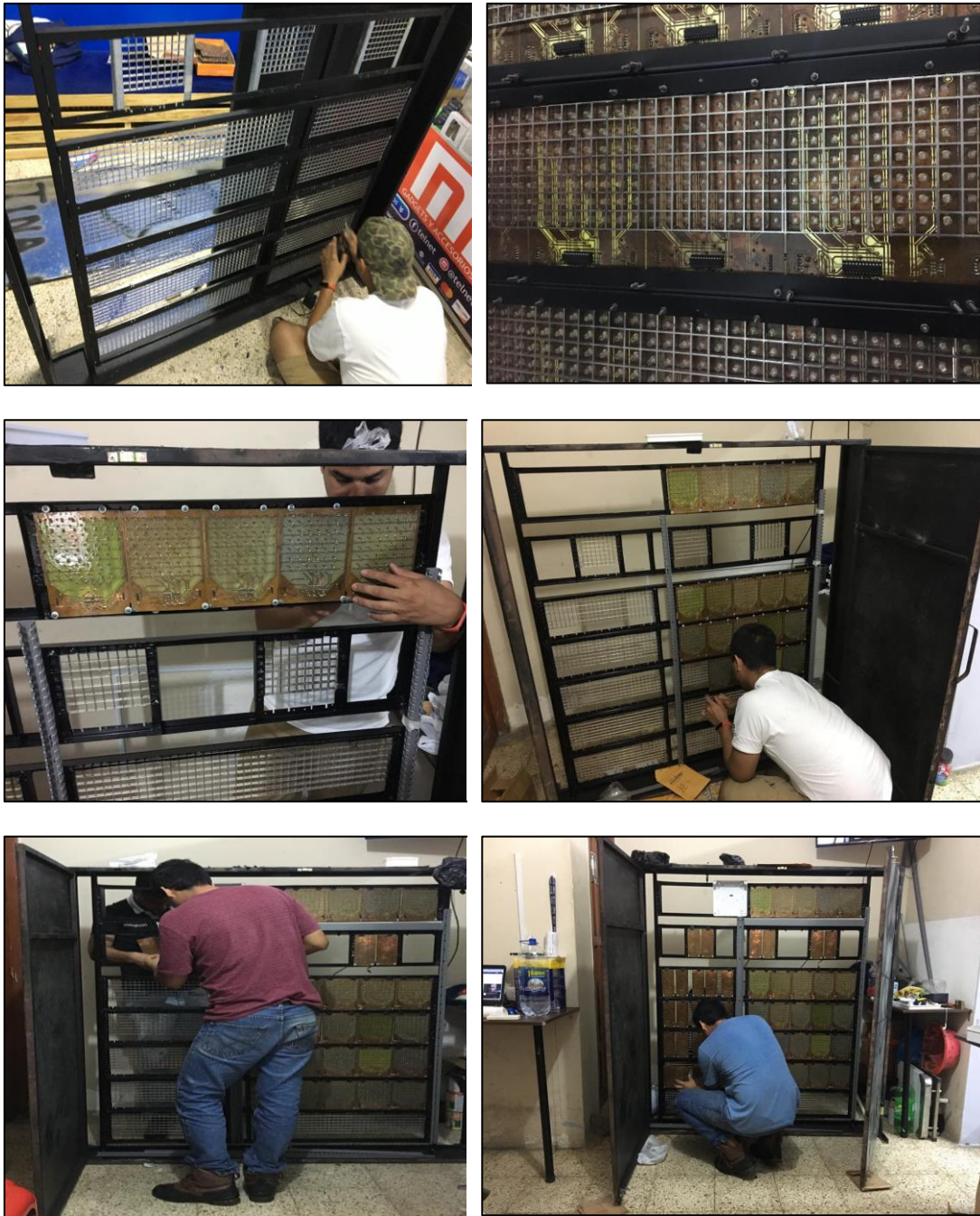
Figura 90- Montaje de placas electrónicas de hileras diodos led
