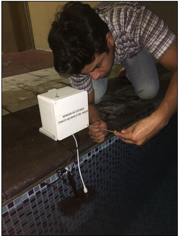
Anexo 1.3- Implementación de los sensores para el estado del agua.
