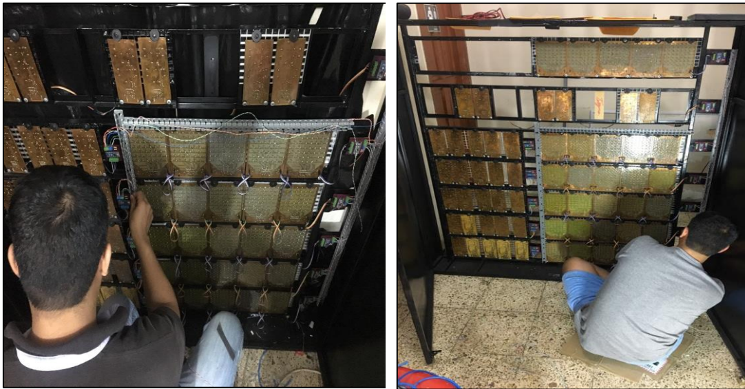
Figura 92- Cableado y ubicación de las placas microcontroladoras y módulo central.
