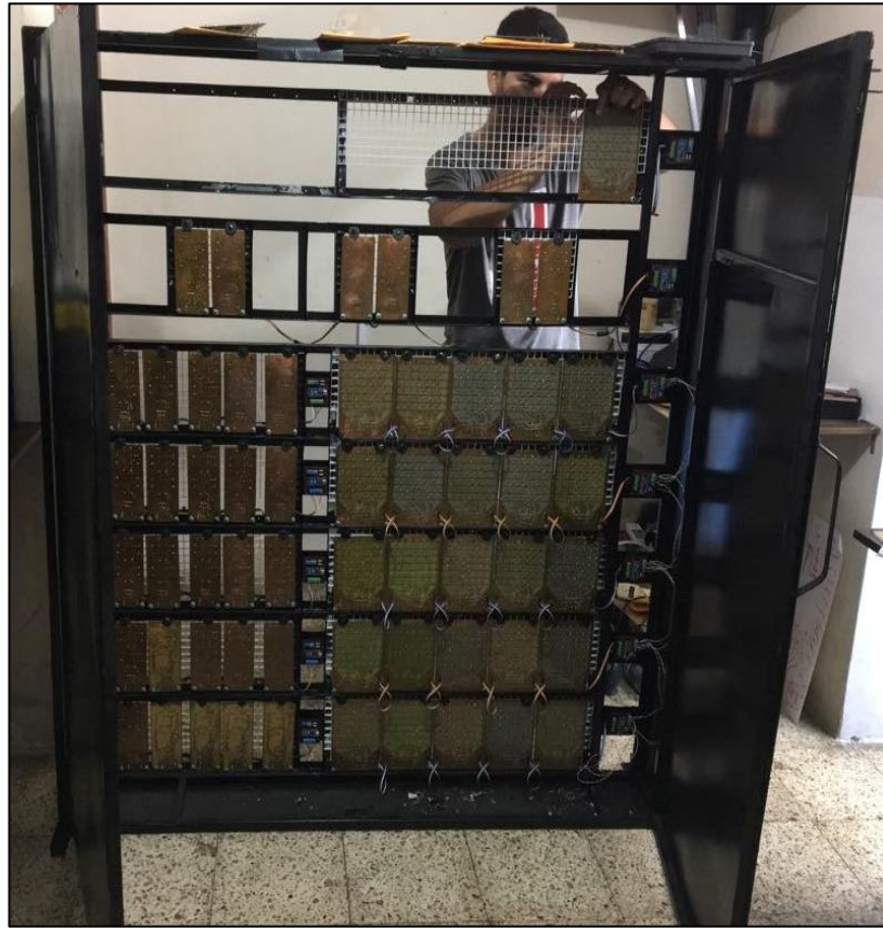
Figura 91- Cableado y ubicación placas electrónicas de hileras diodos led
