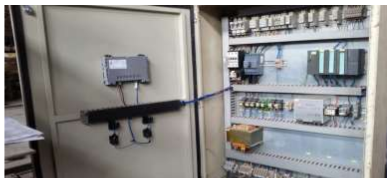
Figura 3.5 Tablero de conexiones eléctricas
