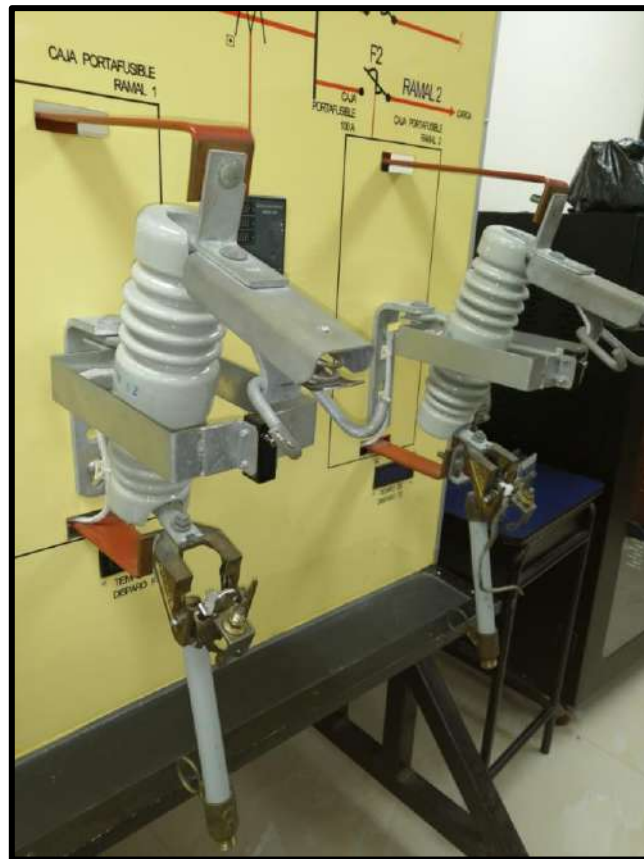
Ilustración 5: Cajas portafusibles montadas en tablero de protecciones.
