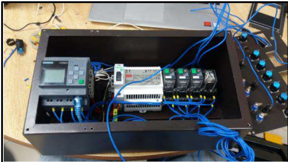
Ilustración 15: Cableado del Modulo
