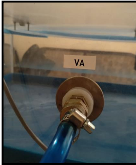
Figura 3.4: Ingreso del Gas GLP
