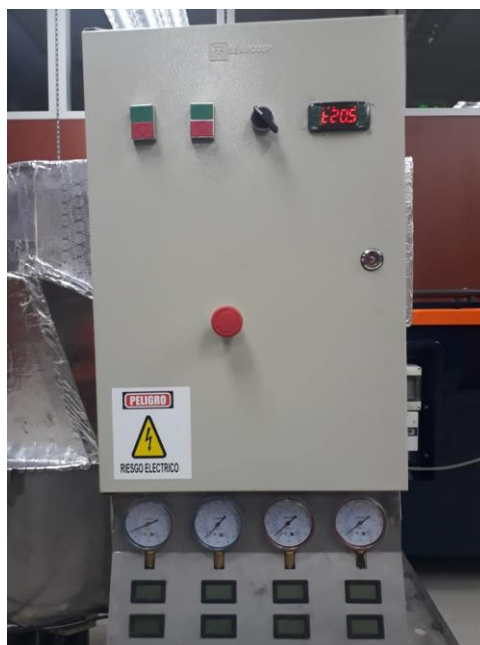
Figura A. 16. Tablero de control, con indicadores de humedad, presión y temperatura.
