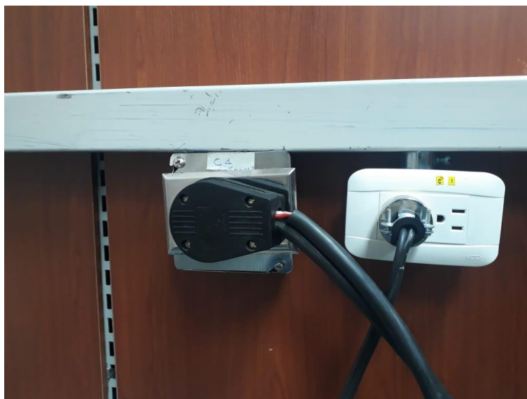
Figura A. 15. Conexión de enchufe industrial a tomacorriente 220 V.
