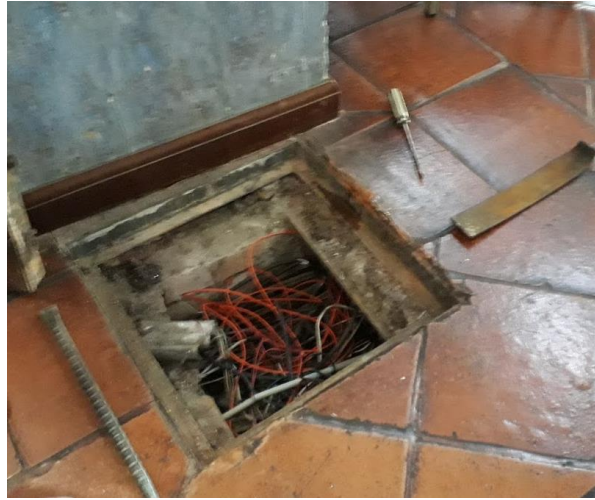
Figura 39 Pozo eléctrico para inspección. Fuente: Autores.
