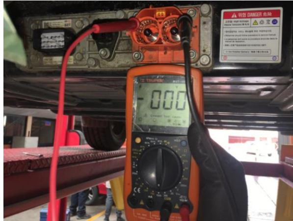
Figura 27: Obtención del voltaje en el inversor. Fuente: Autores.
