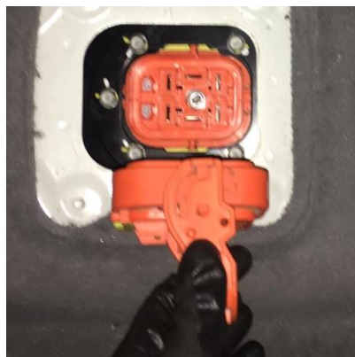
Figura 8: Prevención de seguridad de corte de alto tensión (interruptor Jumper). Fuente: Autores.
