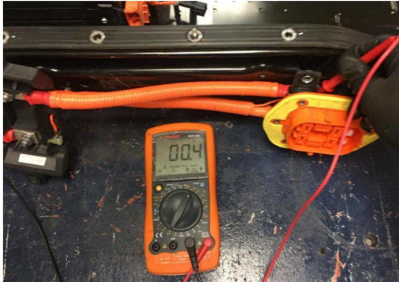
Figura 50: Comprobación del cable del enchufe de seguridad. Fuente: Autores.
