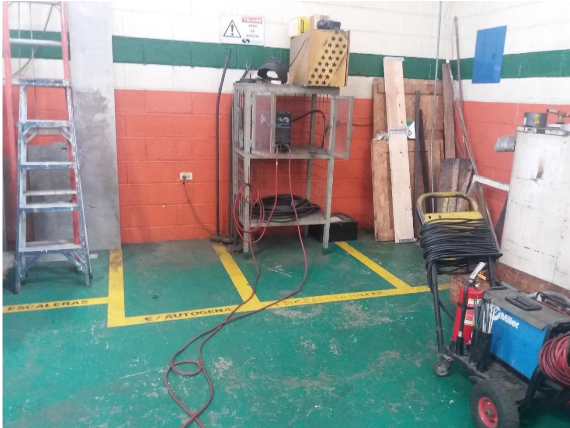
Figura 62.- Sector 4.- Área eléctrica
