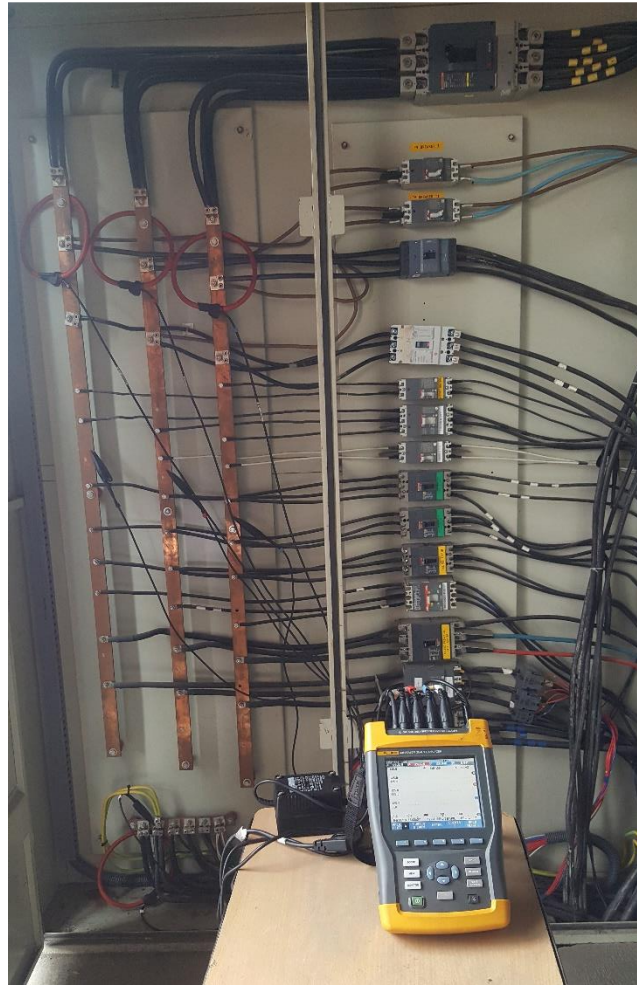
Figura 3-13 Registro de parámetros sobre calidad de energía.
