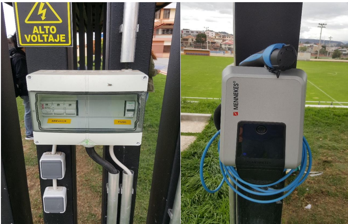
Figura 2-7 Estación de carga.
