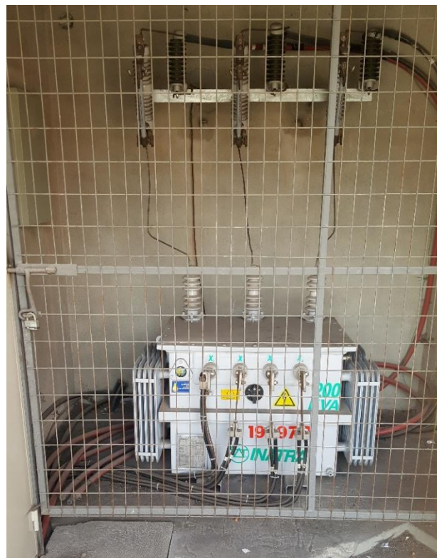
Figura 2-2 Transformador trifásico de 200 KVA.
