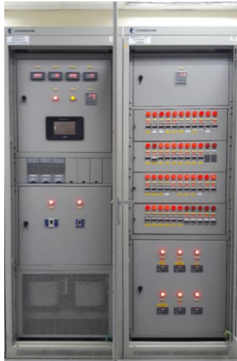
Figura 16. Centro de carga de C.C. Fuente: Autores.
