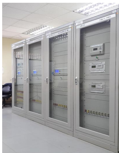
Figura 21. Tableros de sistemas de protecciones. Fuente: Autores.
