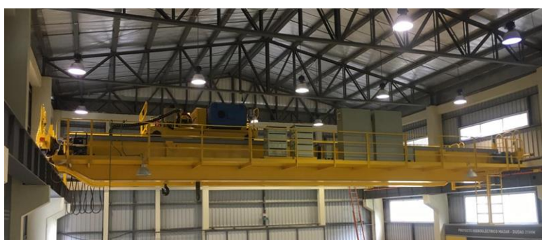
Figura 28. Puente Grúa. Fuente: Autores.
