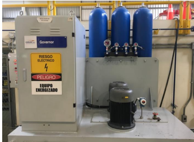
Figura 15. Sistema de regulación de velocidad. Fuente: Autores.
