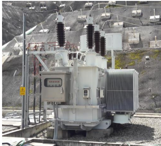
Figura 11. Transformador de Potencia. Fuente: Autores.
