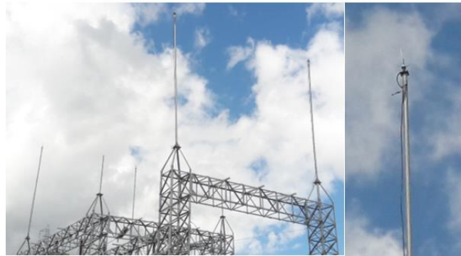
Figura 35. Pararrayos. Fuente: Autores.
