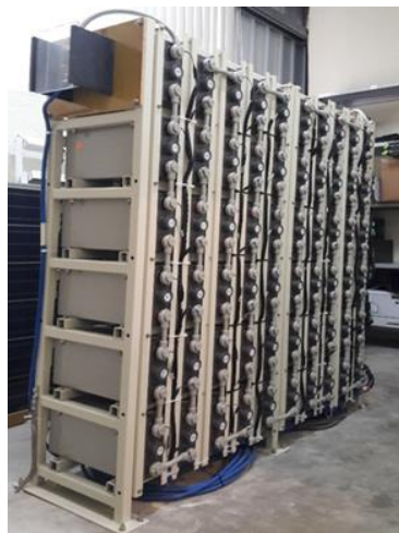
Figura 17. Banco de Baterías. Fuente: Autores.
