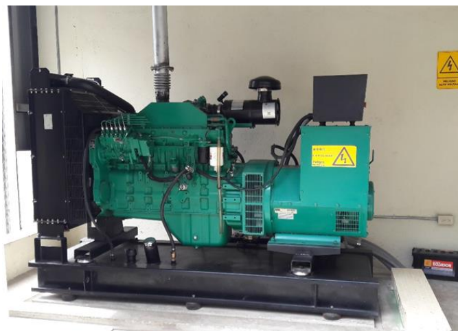
Figura 25. Generador diésel. Fuente: Autores.
