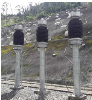
Figura 34. Transformador de Potencial. Fuente: Autores.
