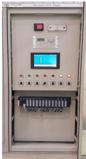
Figura 22. Tablero de Sincronización LCU 1. Fuente: Autores.
