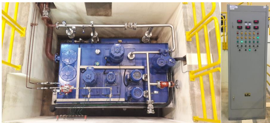
Figura 24. Sistema de lubricación de cojinetes. Fuente: Autores.
