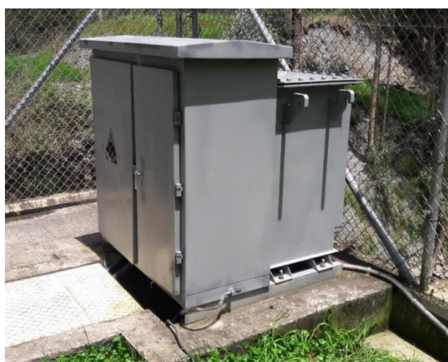
Figura 26. Transformador Auxiliar (PADMOUNTED). Fuente: Autores.
