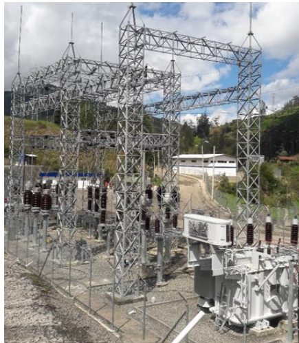
Figura 29. Subestación Alazán. Fuente: Autores.
