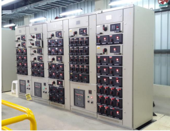
Figura 20. Tableros de bajo voltaje. Fuente: Autores.
