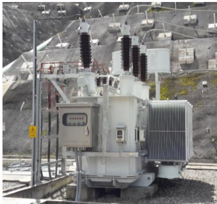
Figura 30. Transformador Principal. Fuente: Autores.
