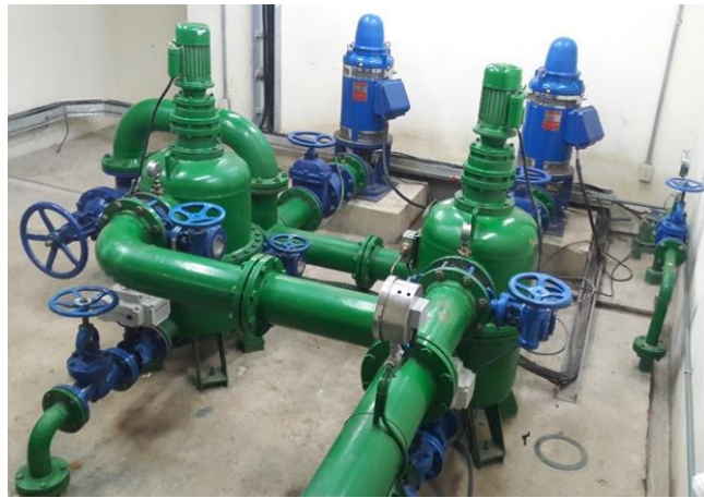
Figura 23. Sistema de agua de enfriamiento. Fuente: Autores.
