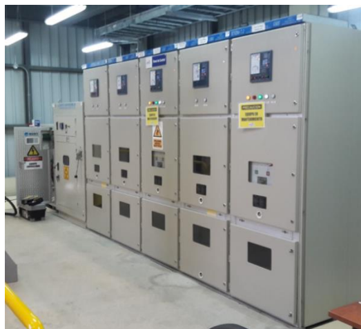
Figura 18. Tableros de medio voltaje. Fuente: Autores.
