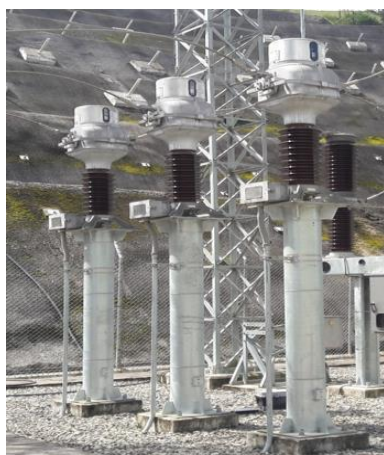
Figura 33. Transformador de corriente (TC). Fuente: Autores.
