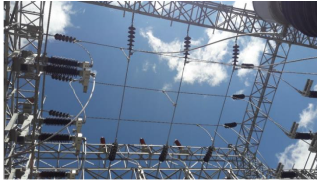
Figura 37. Barra de 69Kv. Fuente: Autores.
