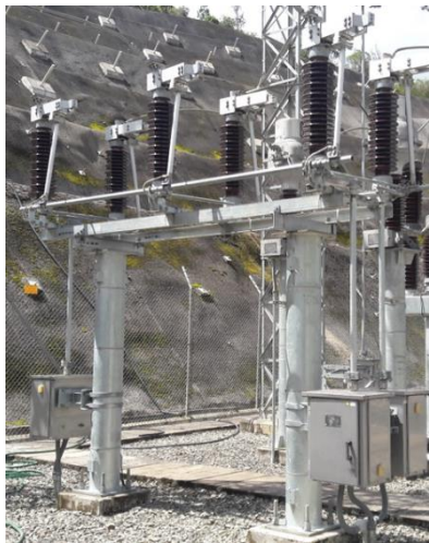
Figura 32. Seccionador. Fuente: Autores.
