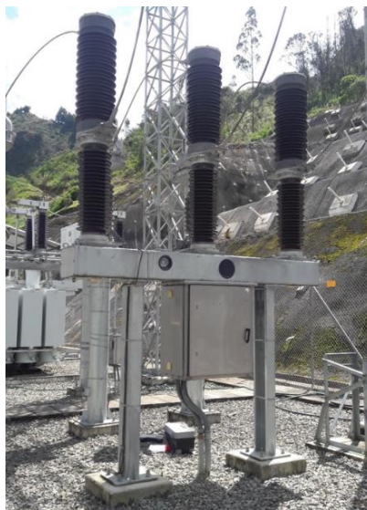
Figura 31. Interruptor de Potencia. Fuente: Autores.
