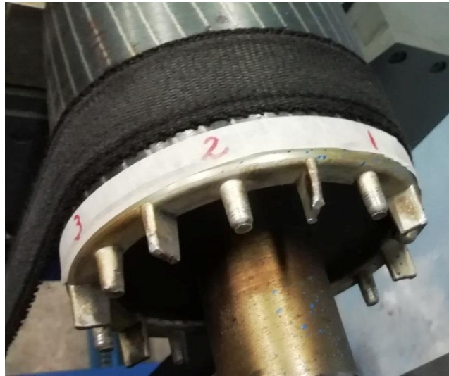
Señalización de los alabes del rotor (Collaguazo Edison, 2019)
