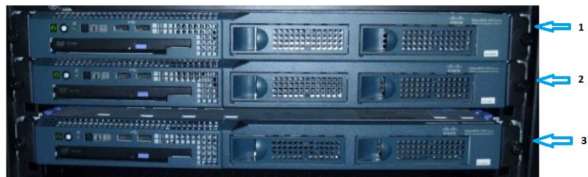
Figura 3.15 Cisco MCS 7800 de la USPQ implementados en el campus El Girón.
