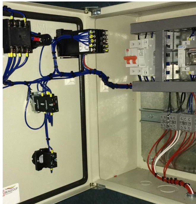
Figura 106 Instalación interna caja de control.
