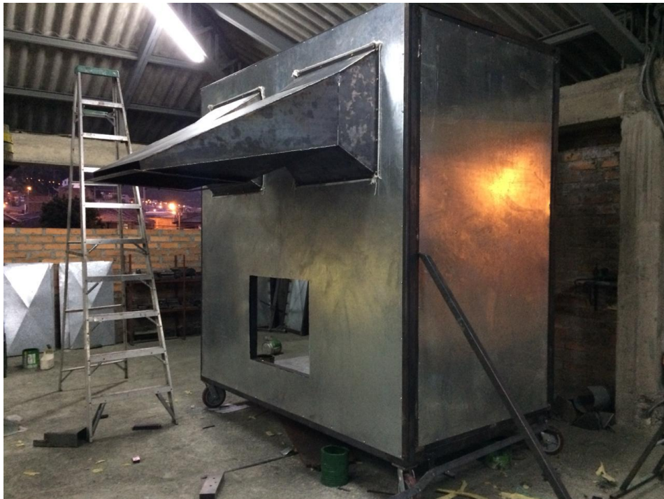
Figura 99 Cabina de curado, ductos, y campanas.
