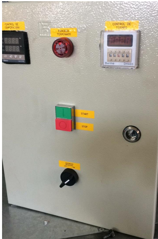
Figura 105 Caja de control.
