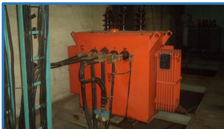
FIGURA 31: TRANSFORMADOR 13.8 KV / 220-127V.
