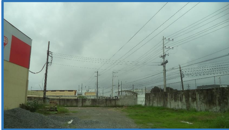
FIGURA 19: RECORRIDO INTERNO EN MEDIA TENSIÓN. FUENTE:
