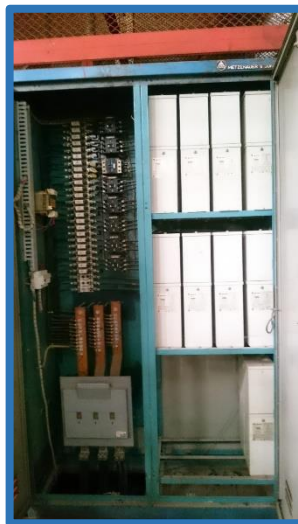
FIGURA 38: INTERIOR TABLERO DE BANCO DE CAPACITORES.
