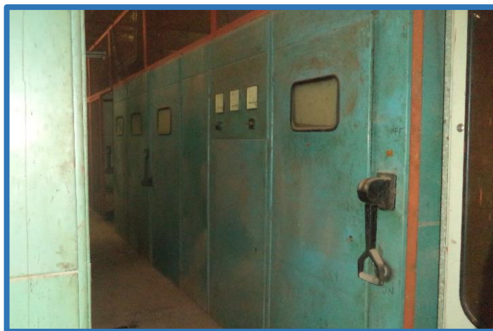
FIGURA 29: CELDAS DE MEDIA TENSIÓN.
