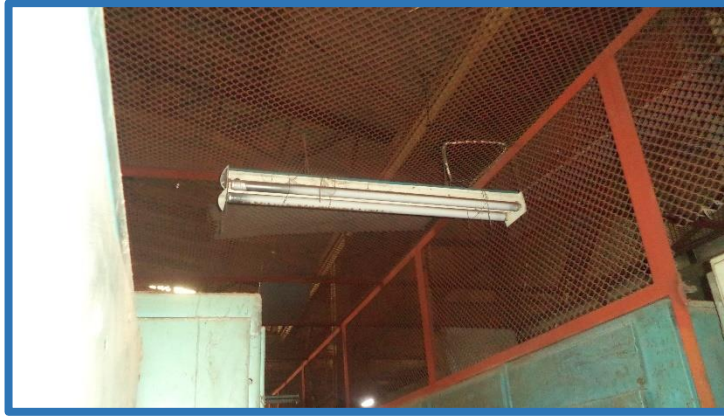
FIGURA 41: LUMINARIA CUARTO DE CELDAS.
