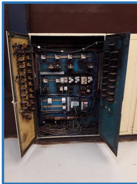
FIGURA 34: INTERIOR TABLERO DE DISTRIBUCIÓN.
