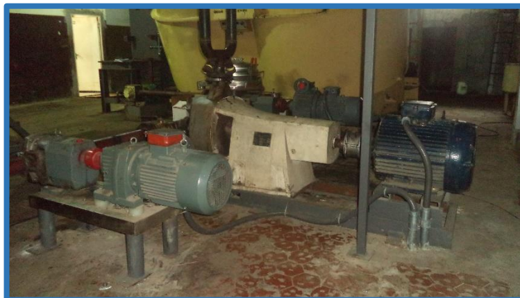
FIGURA 40: MOTORES ELÉCTRICOS ÁREA CONCHAS.
