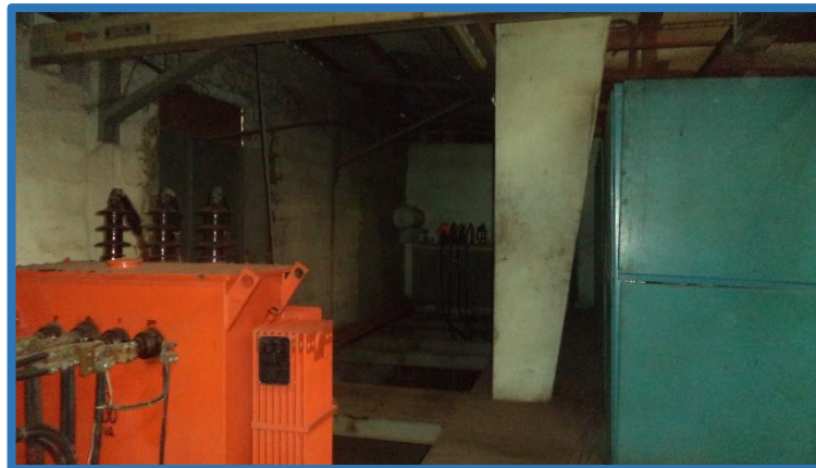
FIGURA 27: INTERIOR DEL CUARTO ELÉCTRICO.
