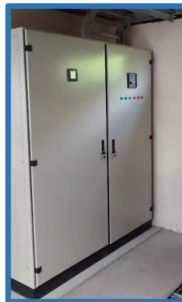
FIGURA 11: TABLEROS DE DISTRIBUCIÓN ELÉCTRICA.
