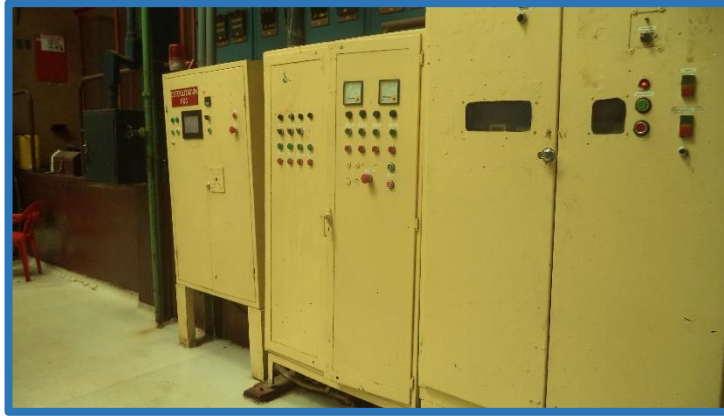
FIGURA 33: TABLEROS DE DISTRIBUCIÓN Y CONTROL ÁREA MOLINOS.
