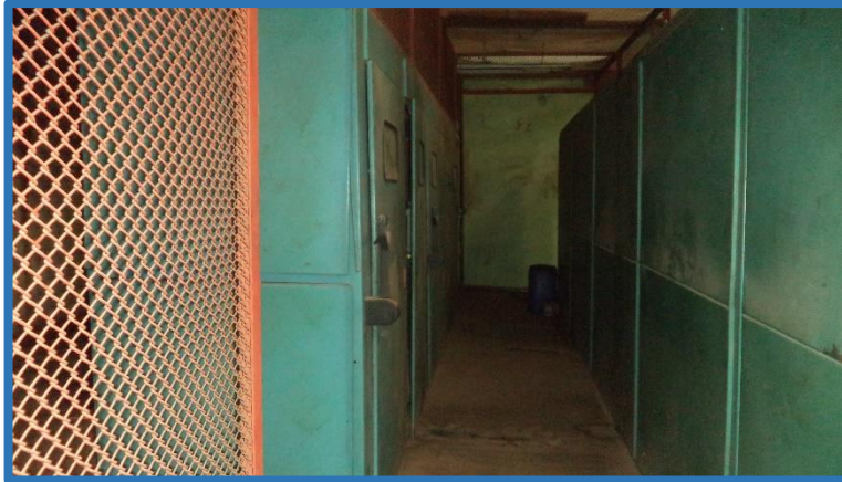
FIGURA 28: INTERIORES DEL CUARTO ELÉCTRICO DETERIORADOS.
