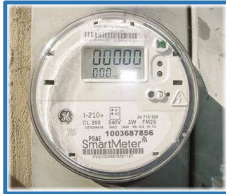
FIGURA 4: MEDIDOR DE ENERGÍA ELÉCTRICA. FUENTE [9]
