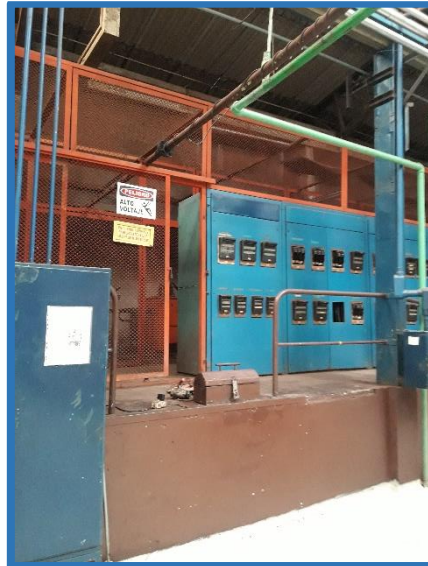
FIGURA 26: INGRESO CUARTO DE TABLEROS.
