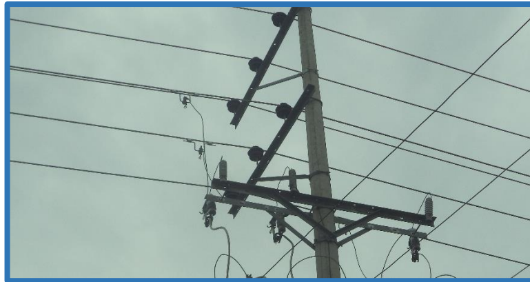
FIGURA 20: EQUIPOS DE SECCIONAMIENTO Y PROTECCIÓN.
