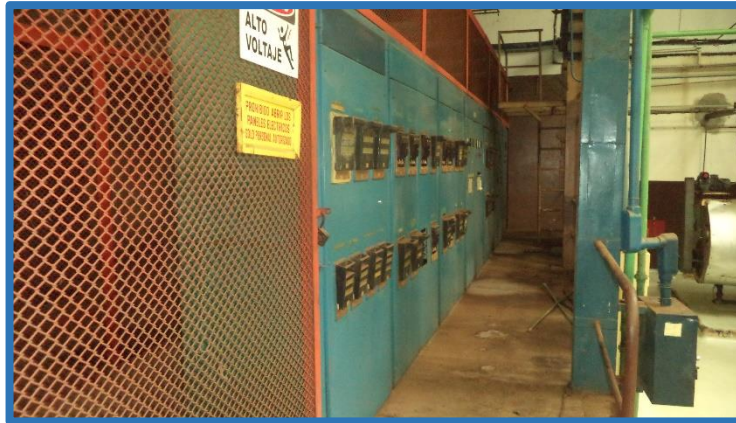
FIGURA 32: TABLEROS DE DISTRIBUCIÓN PRINCIPAL EN BAJA TENSIÓN.
