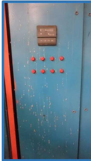
FIGURA 37: TABLERO DE BANCO DE CAPACITORES.
