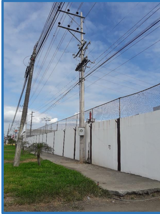
FIGURA 21: POSTE CON MEDICIÓN EN MEDIA TENSIÓN.
