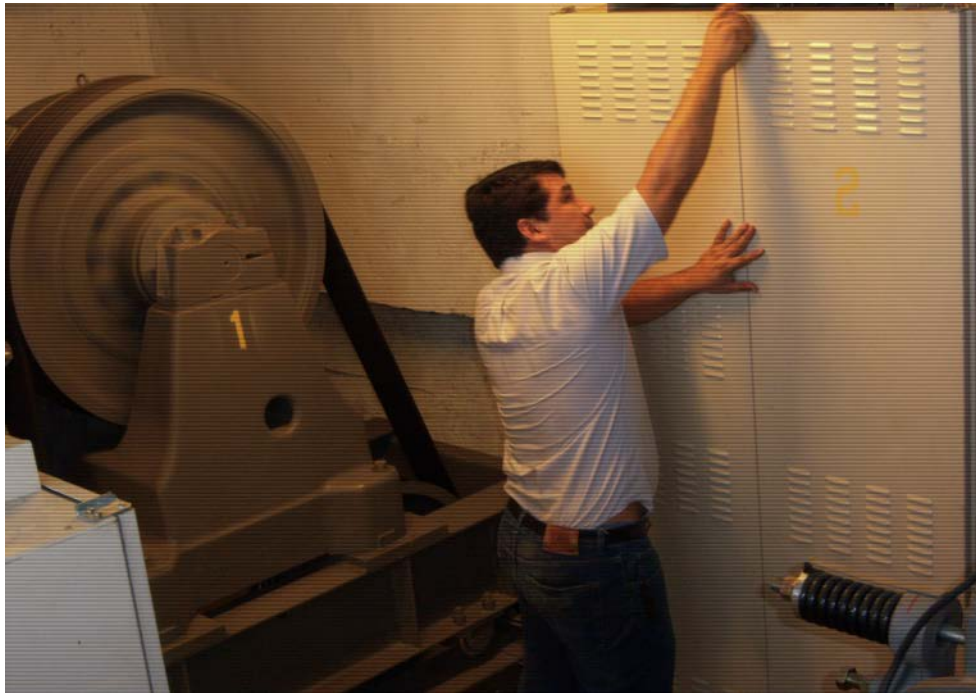
Figura 4.11. Control existente del ascensor # 2 Fuente: Autores 2011
