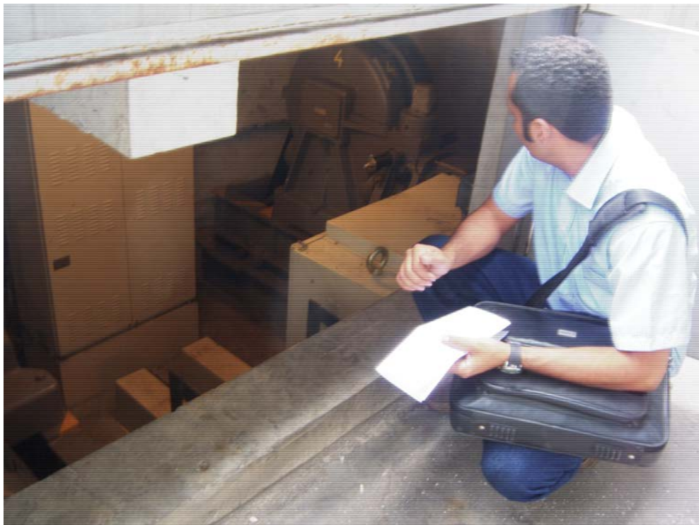
Figura 4.4 Cuarto de control de ascensor 3 y 4
