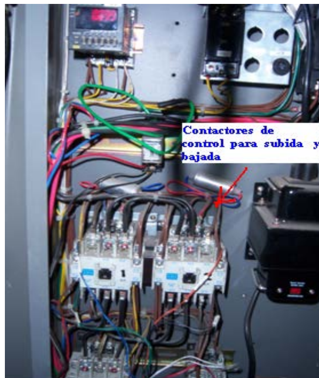
Figura 4.18. Controles Escalera Eléctrica # 5 Fuente: Autores 2011
