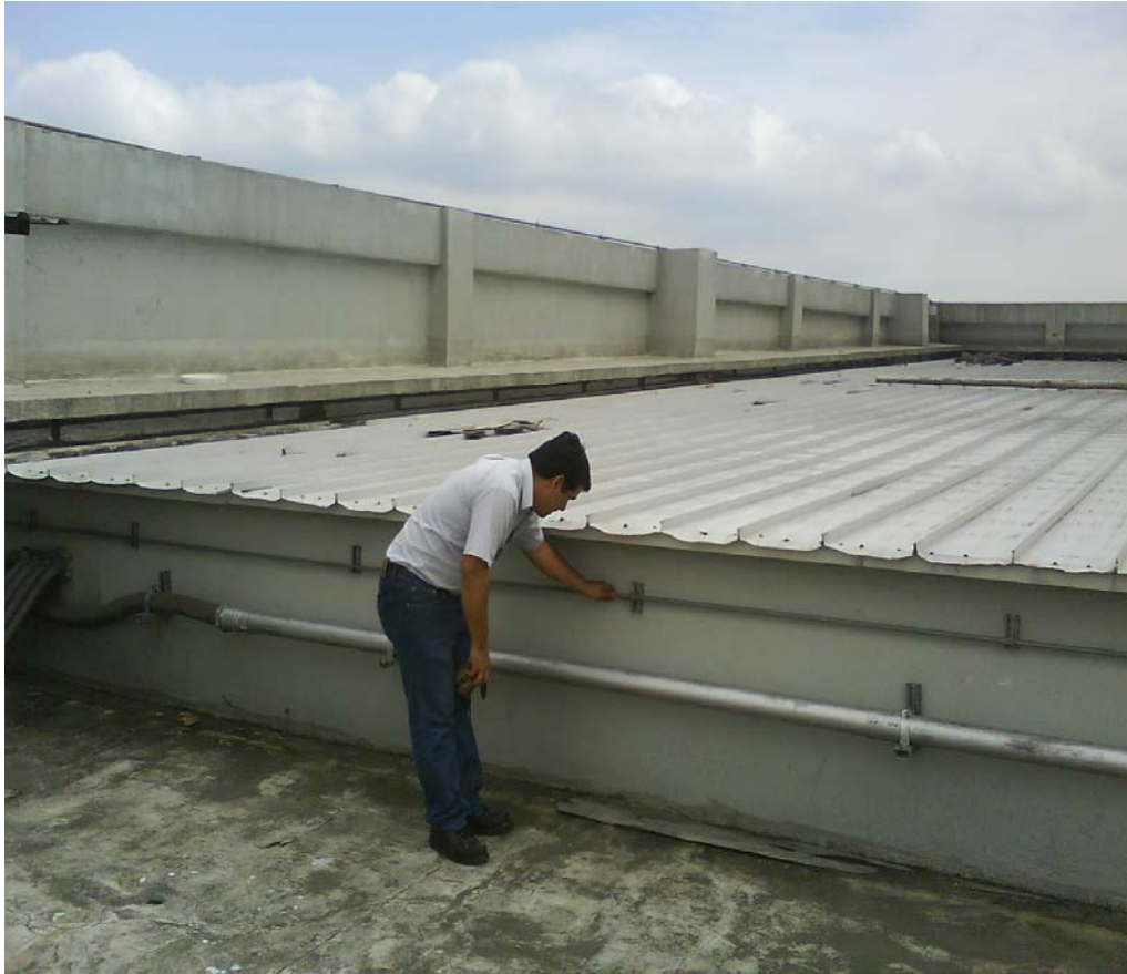
Figura 4.8 Tubería instalada para cable de red
