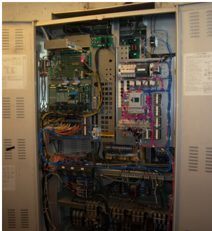
Figura 4.12. Control existente del ascensor Fuente: Autores 2011
