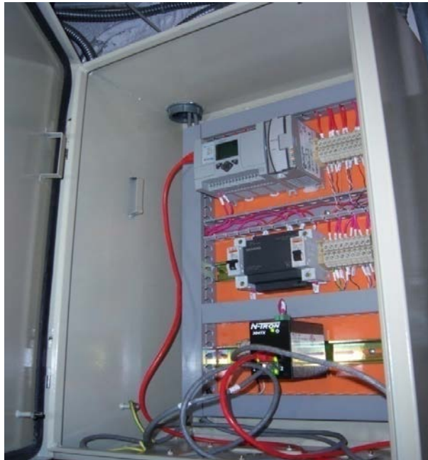
Figura 4.19. Panel instalado en Sala de control Fuente: Autores 2011
