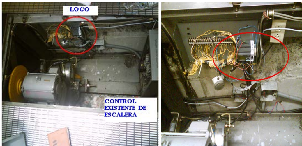
Figura 4.17. Logos Instalados Fuente: Autores 2011
