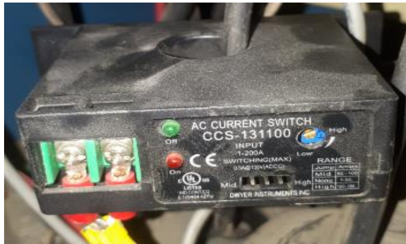
Figura 20 Switch de corriente
