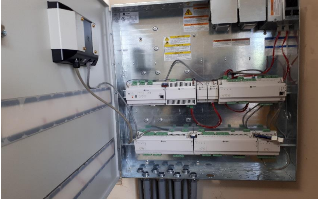
Figura 33 Cableado de alimentación de los módulos de control
