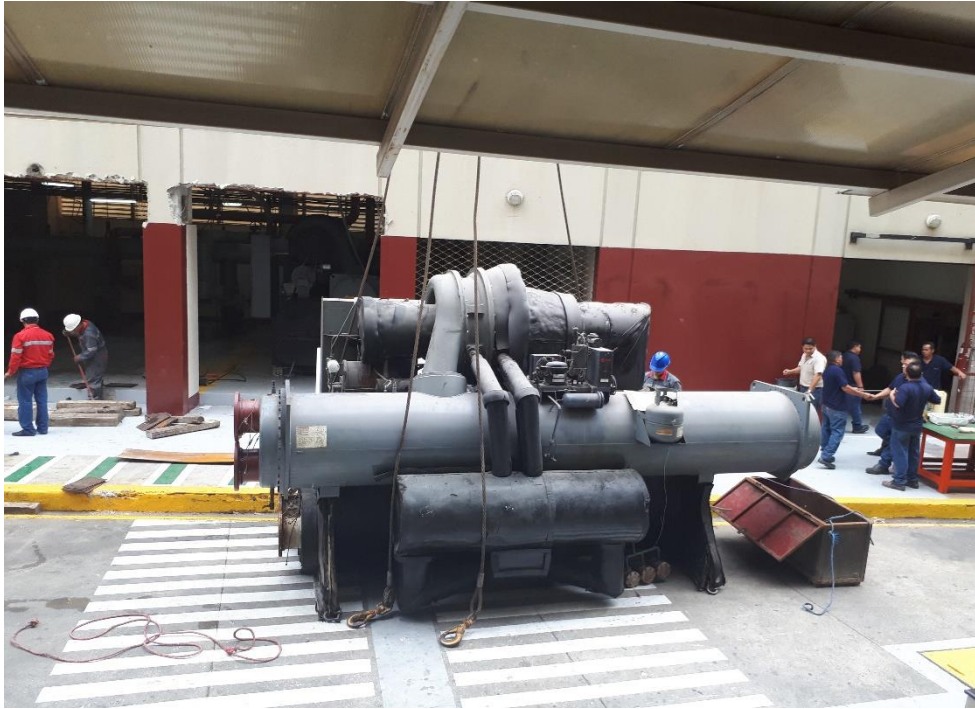
Figura 80 Chillers fue extraído del cuarto de bomba
