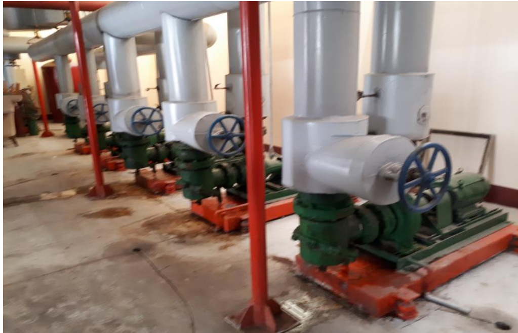
Figura 12 Bomba de agua fría de los Chillers
