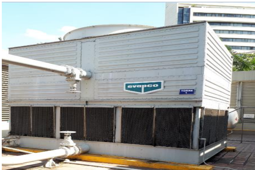
Figura 13 Torre de enfriamiento del Chiller 1
