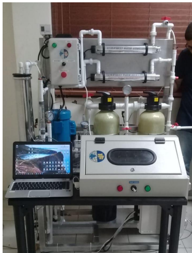
Figura 68. Consola de Control en la planta de purificación de agua.
