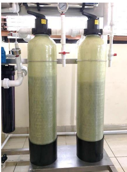
Figura 36. Medios Filtrantes de la planta de purificación.
