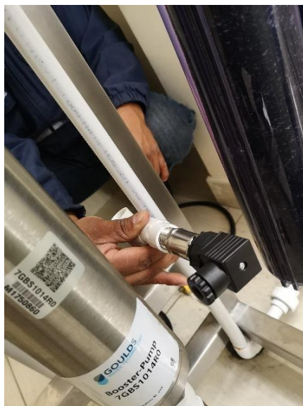
Figura 56. Ubicación e instalación del transductor de presión.
