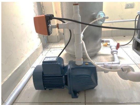
Figura 32. Bomba de ½ hp con automático
