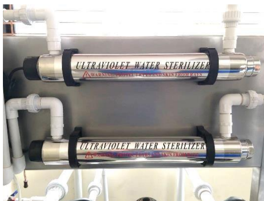
Figura 43. Luz Ultravioleta instalada en la planta
