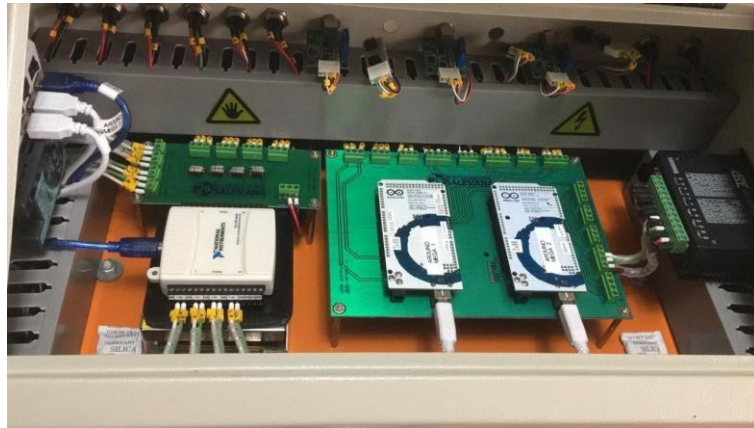
Figura 67. Consola de Control Finalizada.
