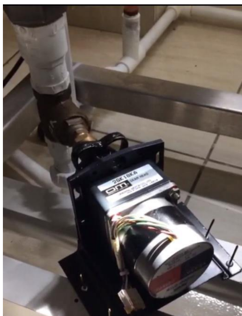
Figura 91. Motor paso a paso ubicado en la válvula de compuerta.
