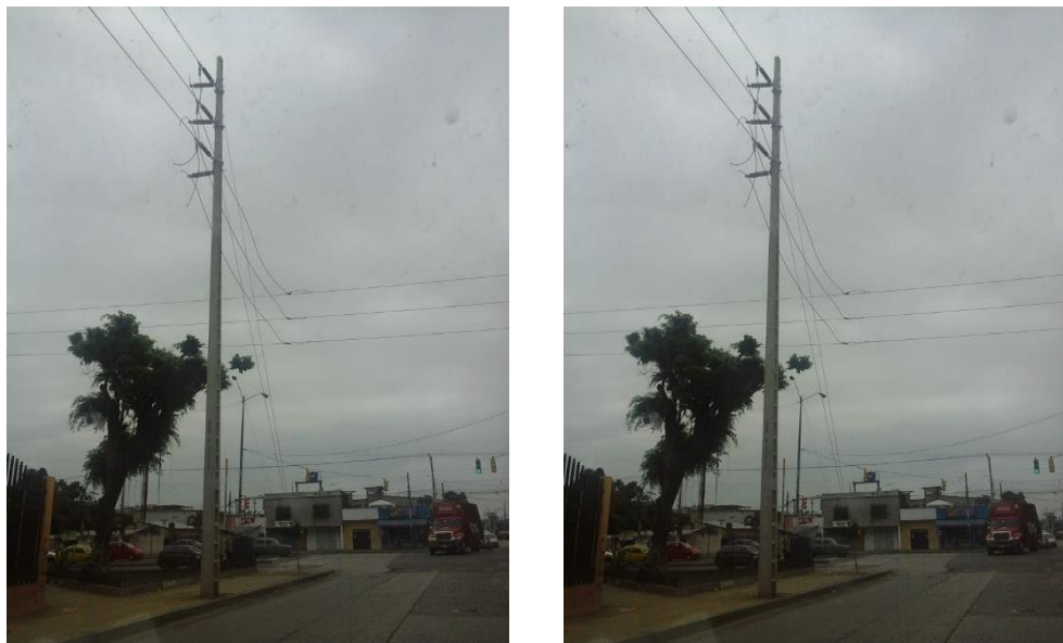
Figura 49: Puente Aéreo de Conductor.
