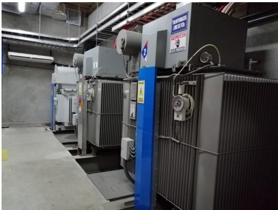
Figura 29. Transformadores de Planta
