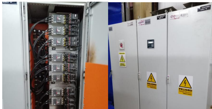
Figura 31. Banco de Capacitores
