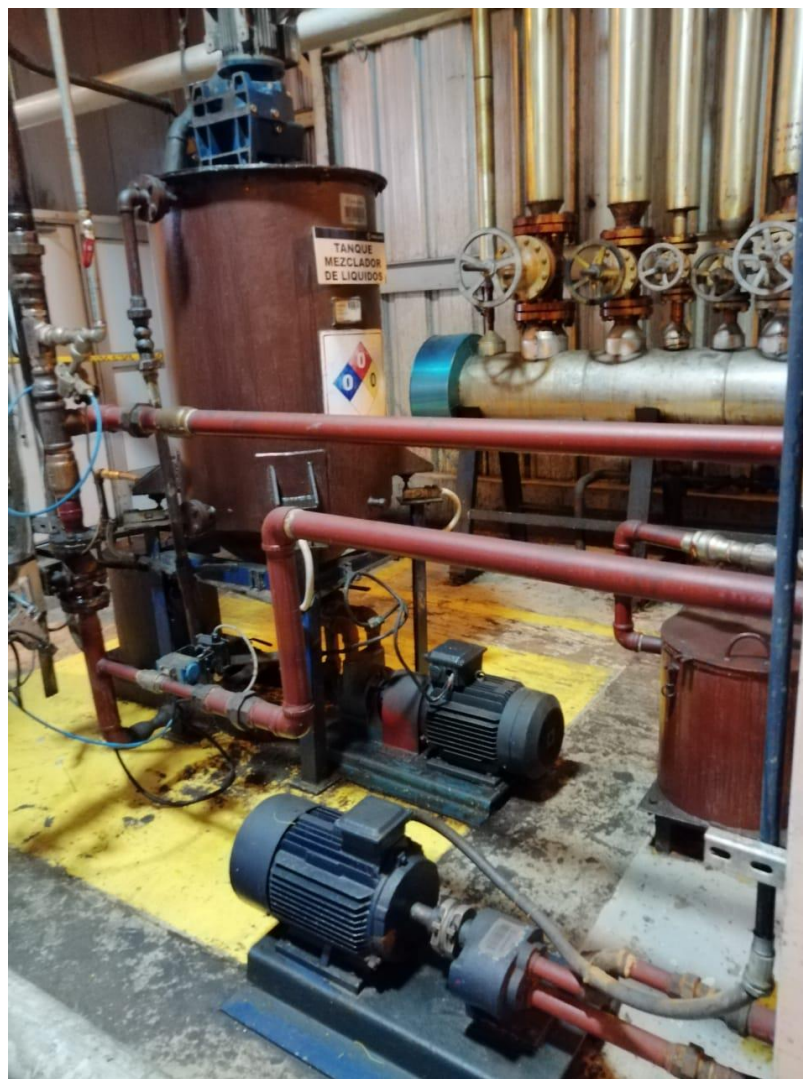
Figura 19. Tanques de Líquidos Fuente: Los Autores
