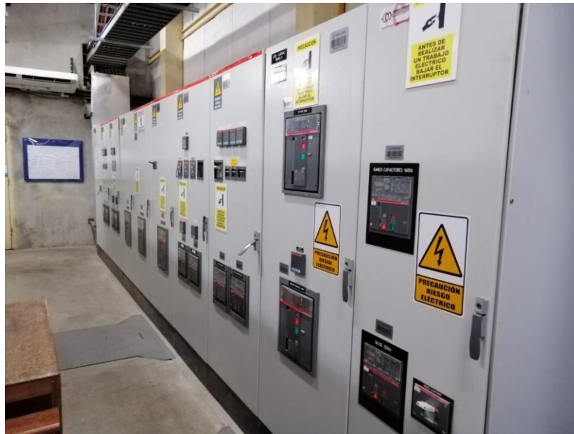
Figura 28. Celdas de Distribución
