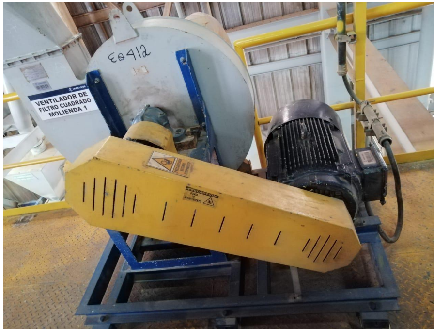
Figura 16. Ventiladores Fuente: Los Autores
