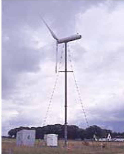
Figura 2.5 Torre de mástil tensado.
