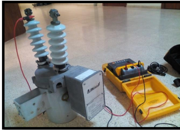
FIGURA 39: PRUEBAS AL SWITCH DE 13,8 KV CON EL MEGGER FLUKE 1550B (CONTACTO-TANQUE / SWITCH ABIERTO)
