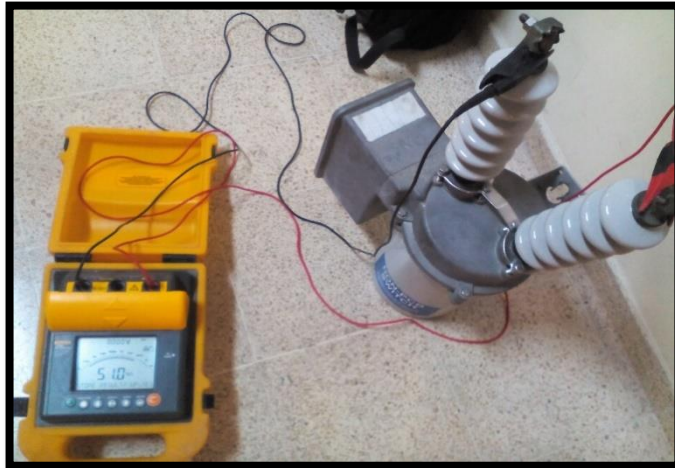
FIGURA 32: PRUEBAS AL SWITCH DE 13,8 KV CON EL MEGGER FLUKE 1550B (CONTACTO-CONTACTO)
