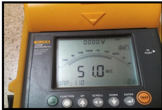
FIGURA 37: DATO DE INDICE DE ABSORCIÓN DIELECTRICA DEL INTERRUPTOR DE MEDIA TENSION (CONTACTO-CONTACTO)
