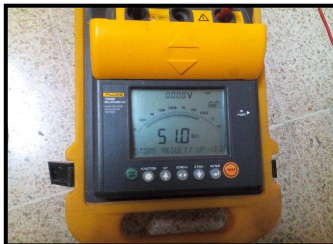
FIGURA 33: DATO DE RESISTENCIA DE AISLAMIENTO DEL INTERRUPTOR DE MEDIA TENSIÓN (CONTACTO-CONTACTO)
