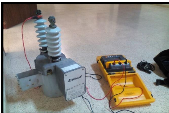
FIGURA 45: PRUEBAS AL SWITCH DE 13,8 KV CON EL MEGGER FLUKE 1550B (CONTACTO-TANQUE / SWITCH CERRADO)
