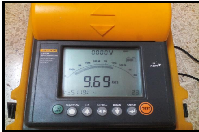
FIGURA 48: DATO DE VOLTAJE INYECTADO AL INTERRUPTOR DE MEDIA TENSIÓN (CONTACTO- TANQUE / SWITCH CERRADO)
