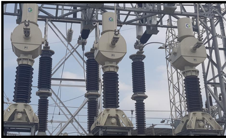
FIGURA 17 TRANSFORMADOR DE CORRIENTE
