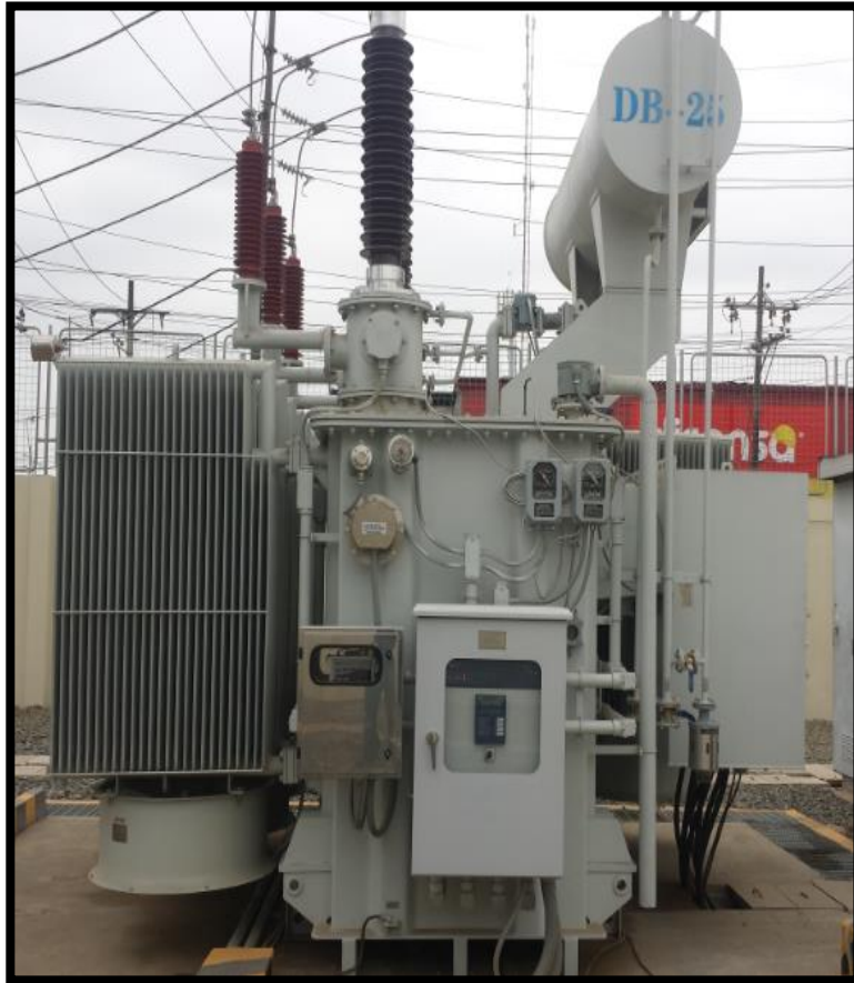
FIGURA 16 TRANSFORMADOR DE POTENCIA 69/13 8KV
