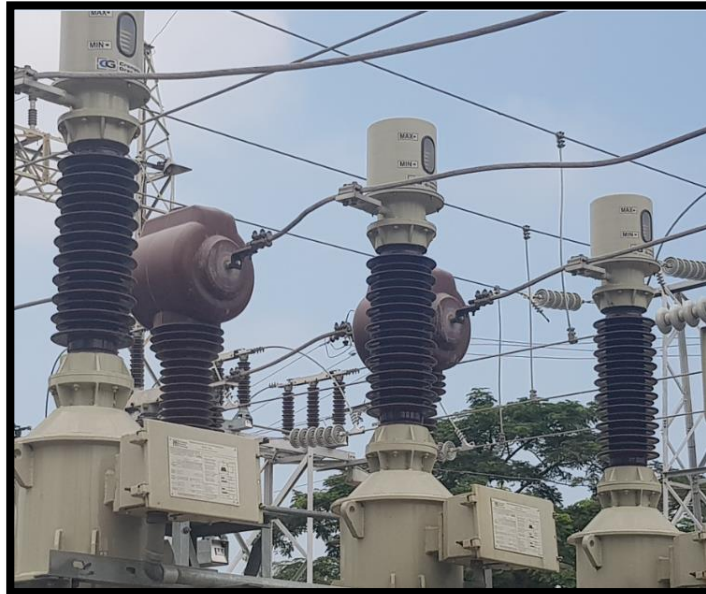
FIGURA 18 TRANSFORMADOR DE TENSIÓN
