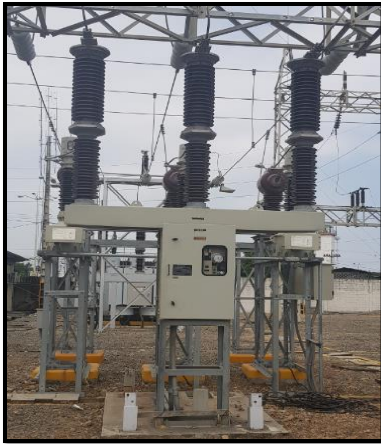
FIGURA 11 INTERRUCTOR A GAS EN SF6 A NIVEL DE 69 KV
