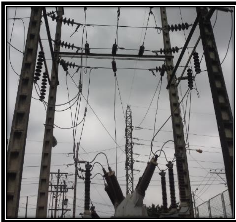
FIGURA 12 INTERRUCTORES DE LÍNEA TANQUE VIVO
