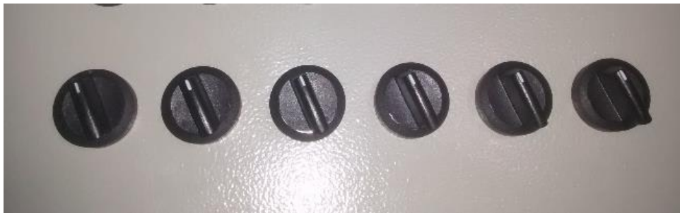
Figura 42. Selectores de control de módulo didáctico. (Los Autores).
