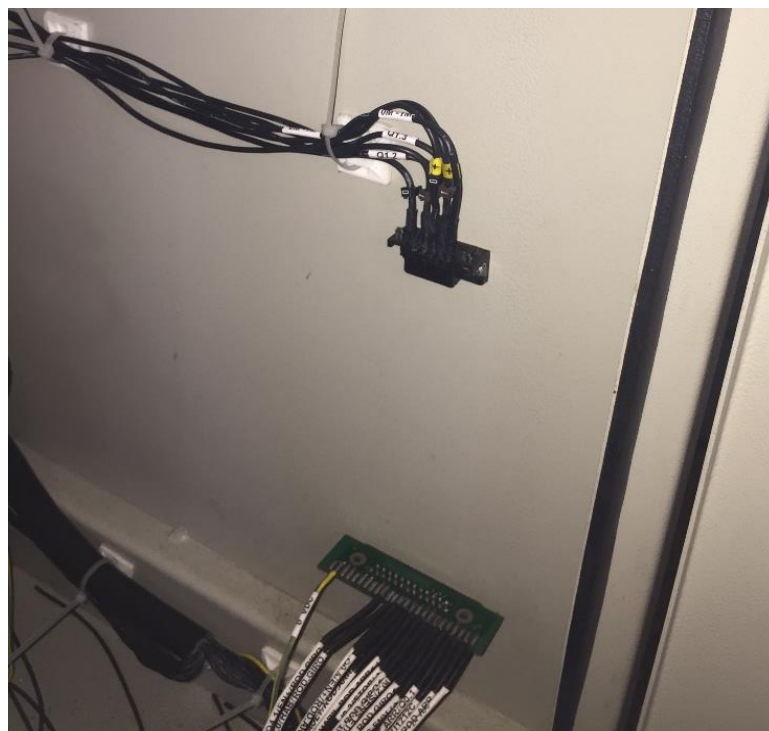
Figura 126. Conectores DB25-DB9 en tablero de etiquetadora. (Los Autores).
