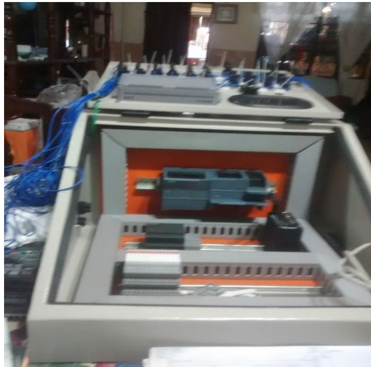
Figura 115. Ubicacion de elementos internos de control para modulo didáctico. (Los Autores)
