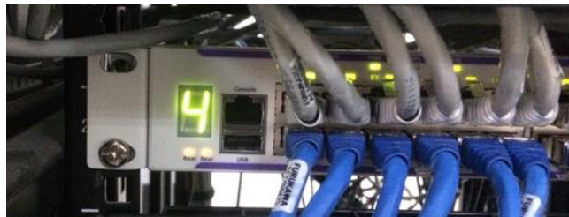
Imagen 43 Switch 4to en modo IDLE dentro del stack
