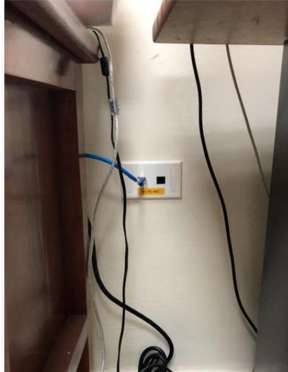
Imagen 138 Punto de red instalado
