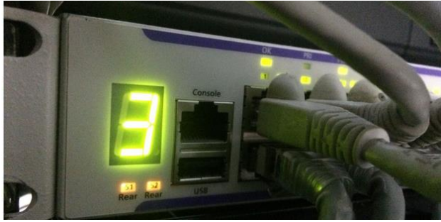
Imagen 42 Switch 3ro en modo IDLE dentro del stack
