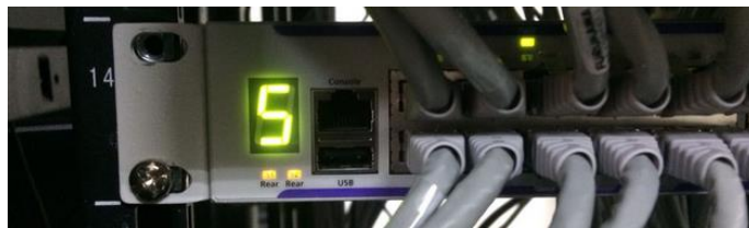
Imagen 44 Switch 5to en modo IDLE dentro del stack
