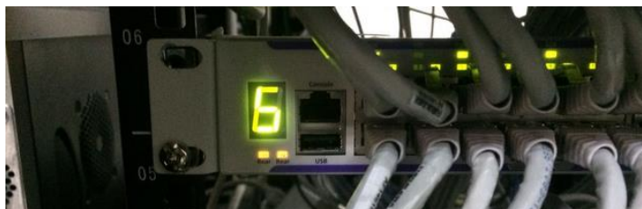
Imagen 45 Switch 6to en modo IDLE dentro del stack
