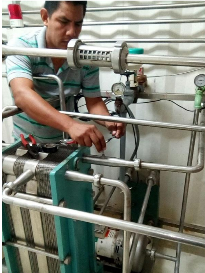
Figura 47. Instalación del Sensor Pt100 Elaborado por: Autor
