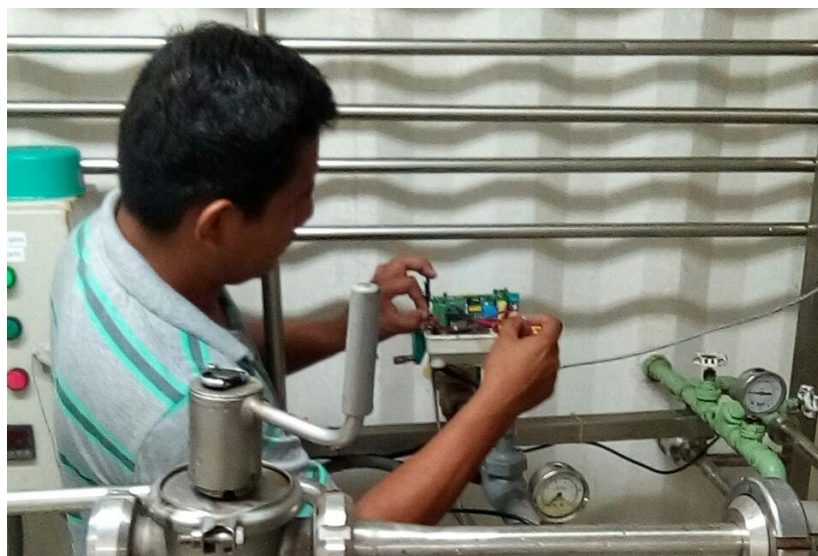
Figura 46. Calibración de válvula eléctrica de posicionamiento Elaborado por: Autor
