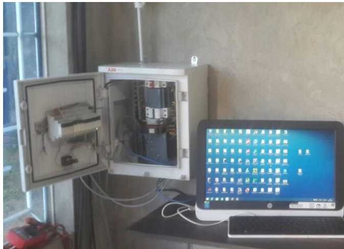
Figura 51. Conexión los equipos del tablero de control Elaborado por: Autor
