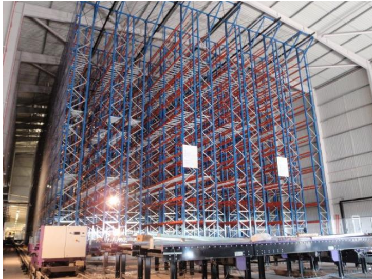
Figura 13. Proceso automático industrial con transelevadores. (NOEGA System, 2016)
