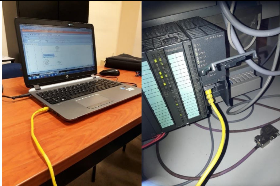
Figura 254. Conexión Ethernet al PC y PLC S7-314C 2DP
