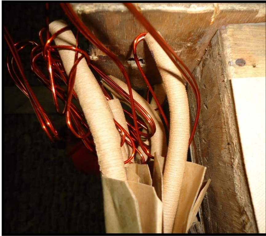
FIGURA D. 5: TERMINALES DE LOS DEVANADOS DE ALTA Y BAJA TENSIÓN.
