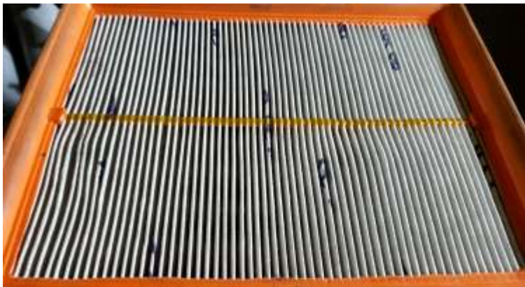
Figura A - 15. Estado del filtro de aire de la unidad en estudio. Fuente: Autores.
