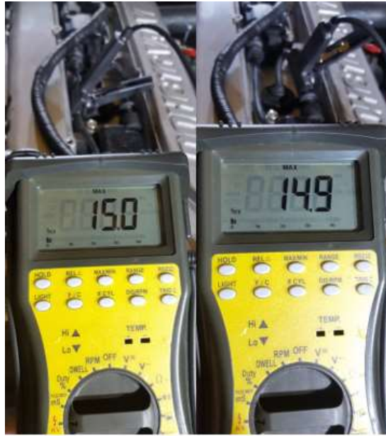
Figura A - 21. Verificación de la tensión del secundario de las bobinas de encendido de la unidad experimental, en ralentí. Fuente: Autores.
